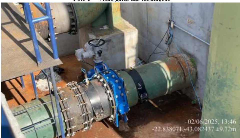
Foto 6 – Tubulação com válvula controladora de nível
