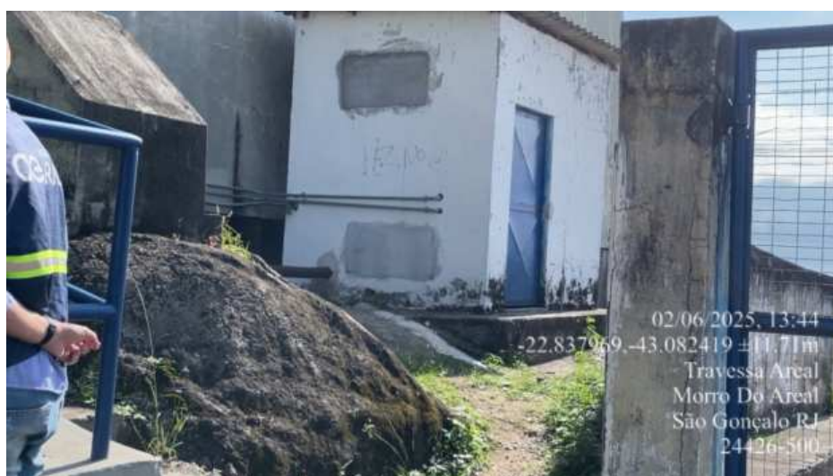
Foto 4 – Estrutura onde está painel de comando
