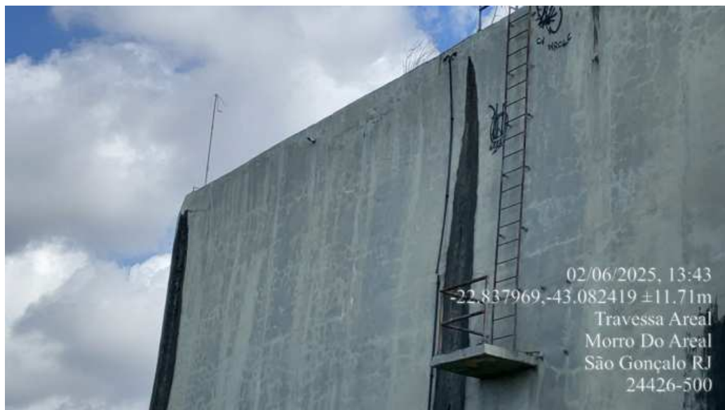
Foto 3 – Para-raio e escada sem proteção vistos de perto
