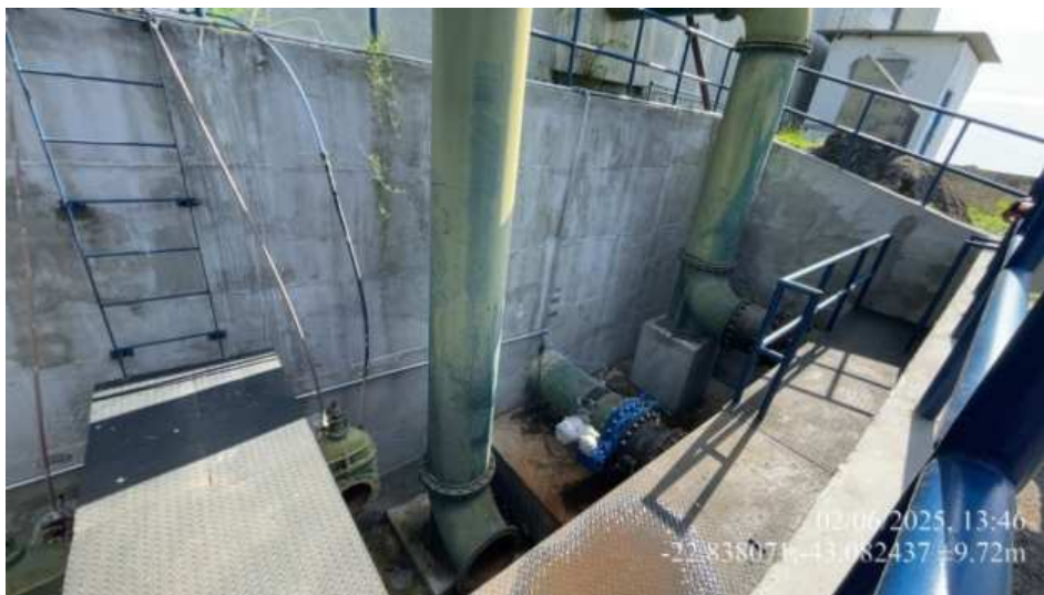
Foto 5 – Visão geral das tubulações
