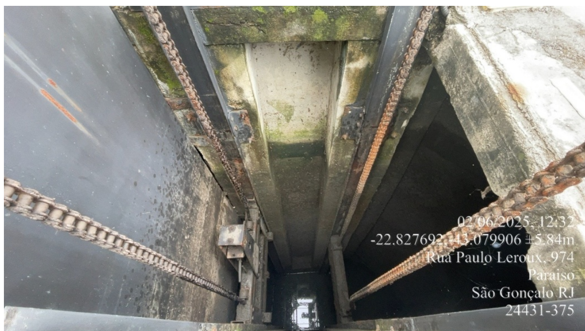
Foto 4 – Estrutura de gradeamento da EEEB Paul Leroux
