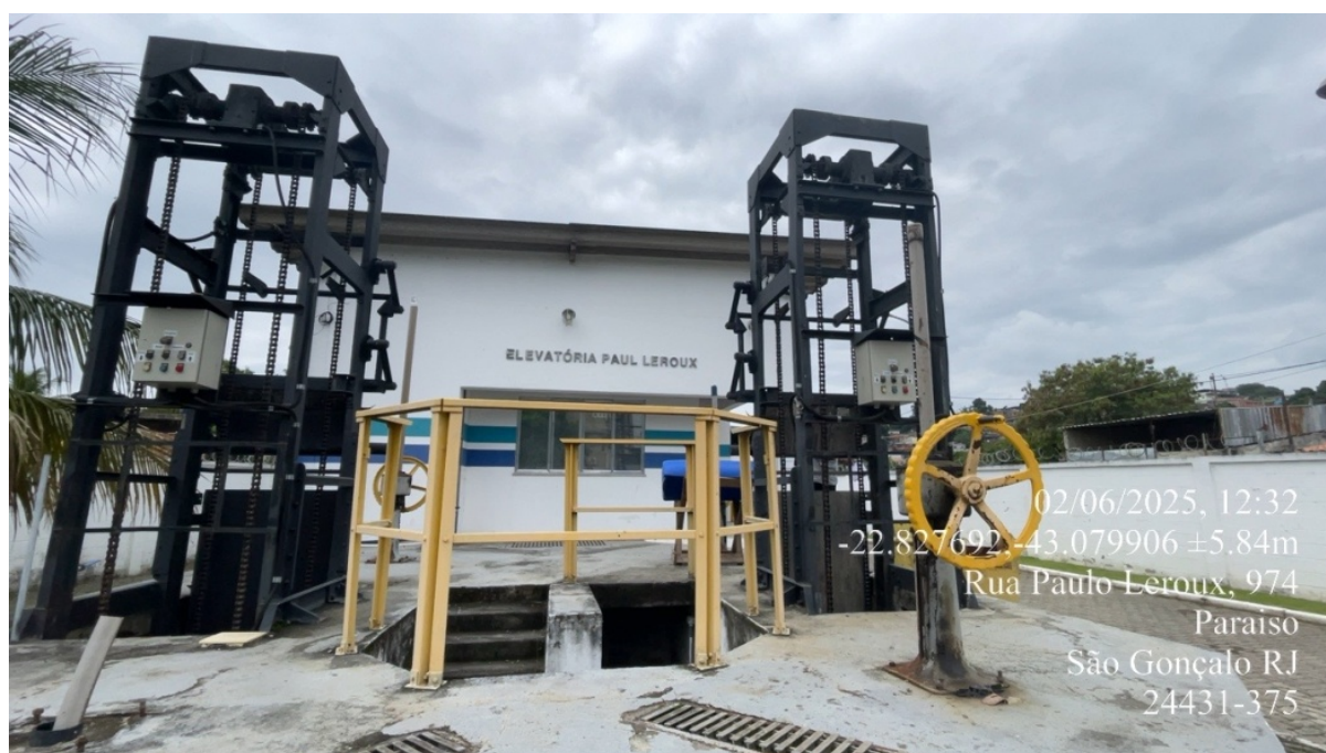
Foto 2 – 2 (dois) gradeamentos mecanizados
