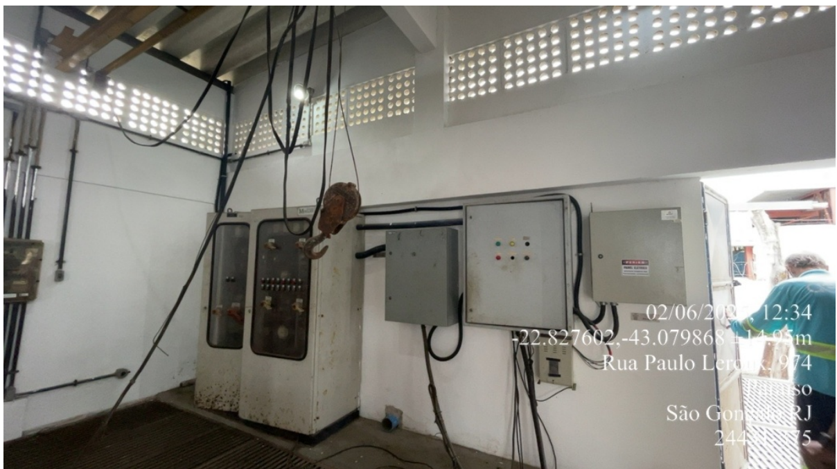
Foto 6 – Painel de comando EEEB Paul Leroux
