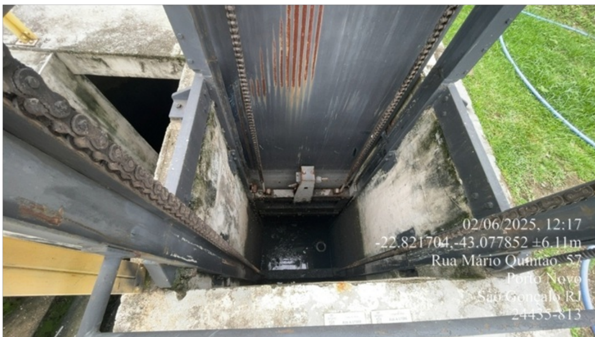
Foto 3 – Estrutura de gradeamento da EEEB Mário Quintão
