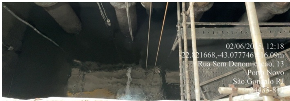
Foto 4 – Poço de sucção
