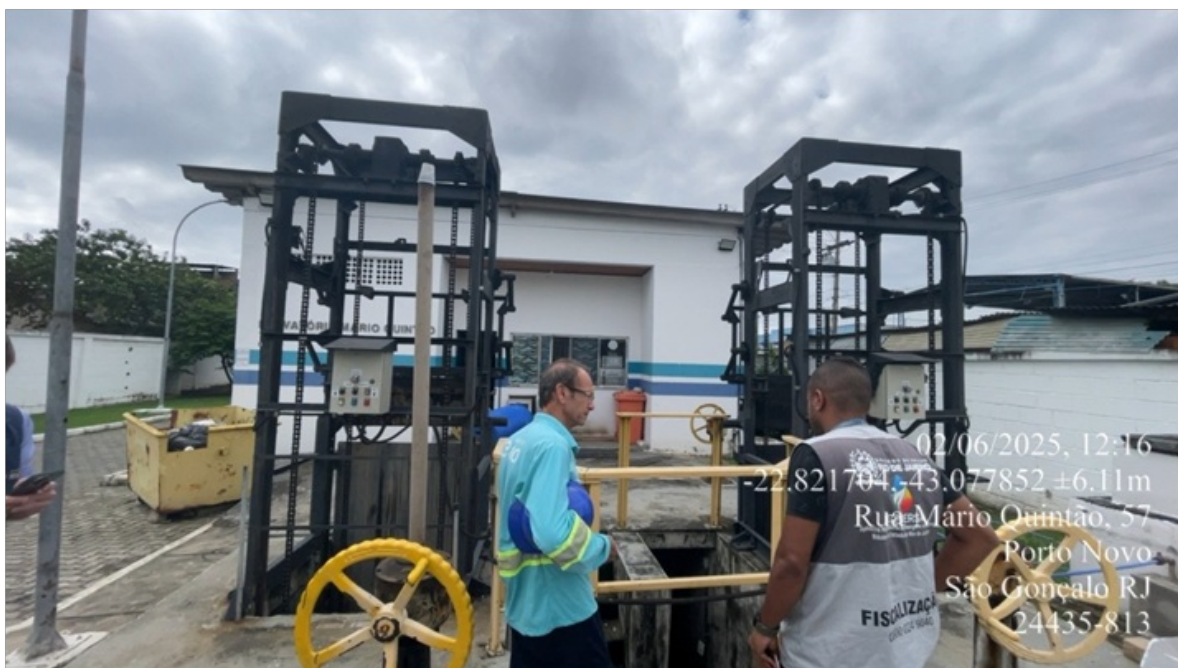
Foto 2 – 2 (dois) gradeamentos mecanizados
