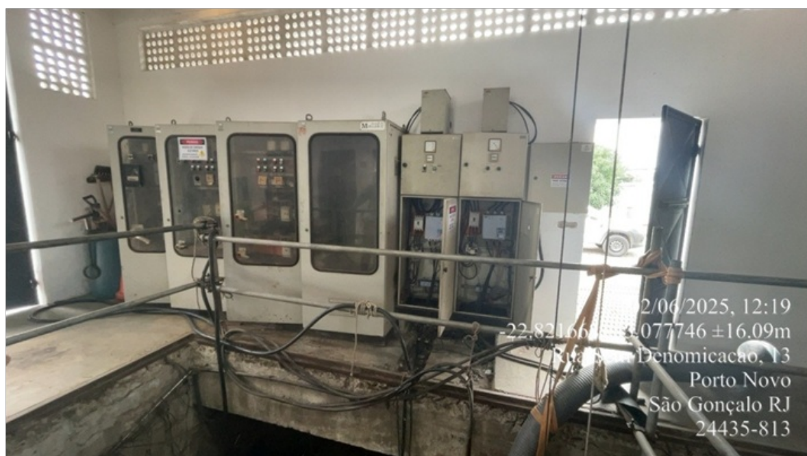
Foto 5 – Paineis das motobombas
