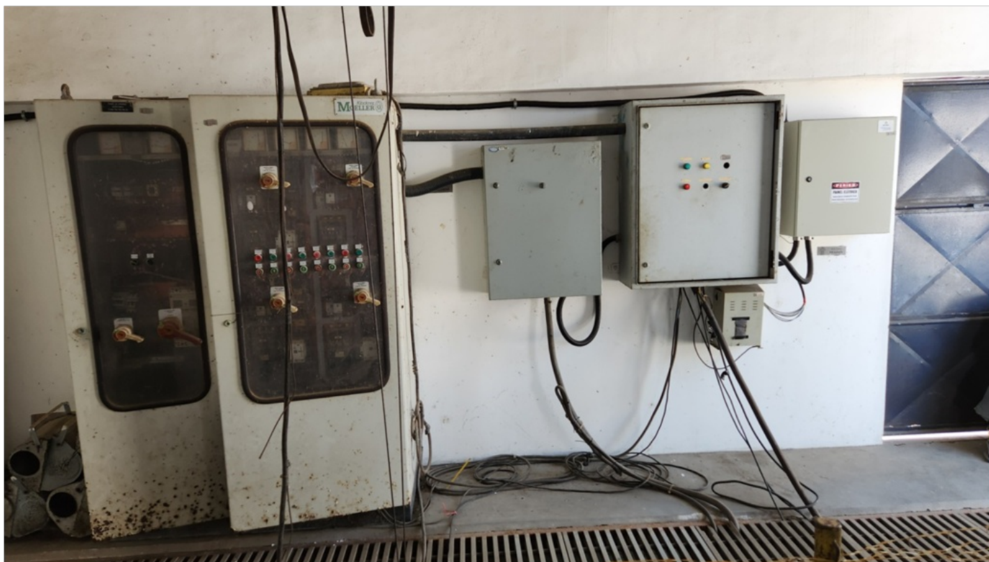
Foto 6 – Quadros de elétrica e comando desativados e quadros de elétrica e comando em operação
