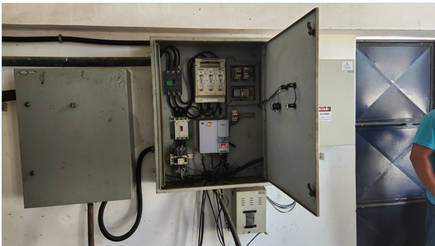
Foto 7 – Quadro de elétrico e comando
