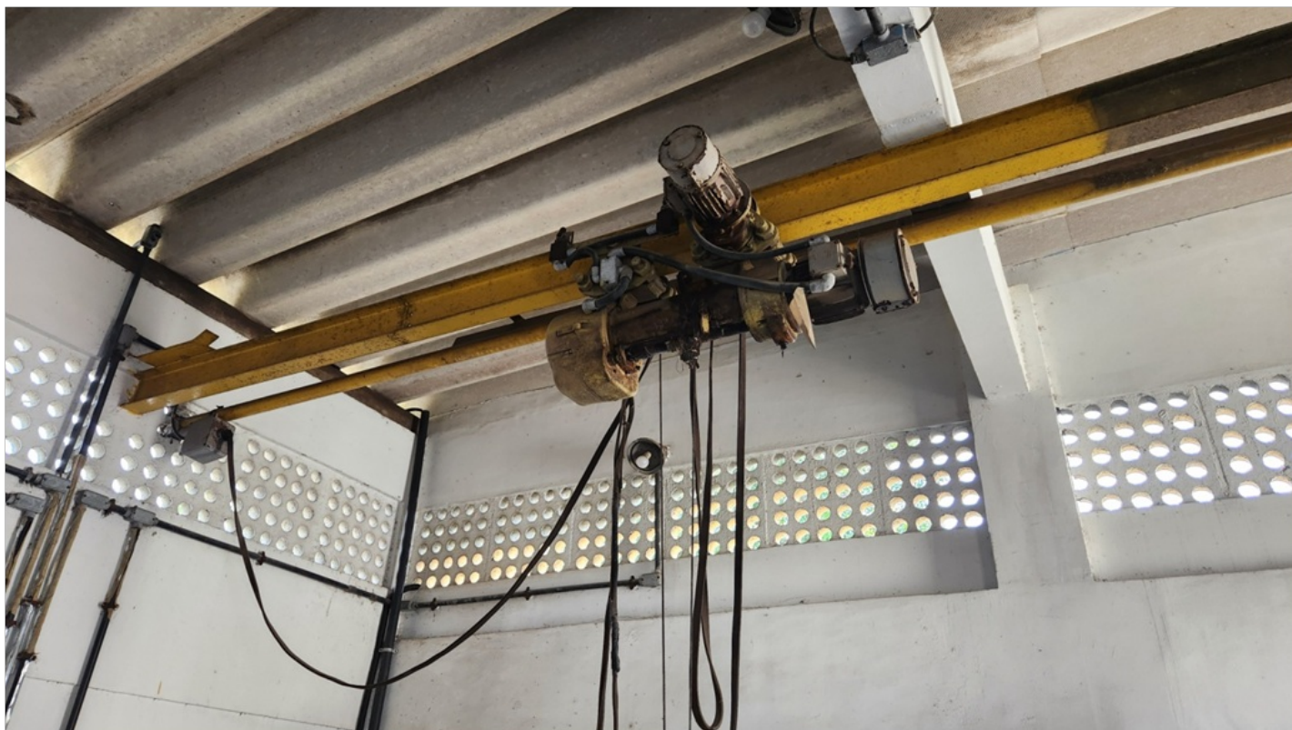
Foto 9 – Ponte rolante motorizada
