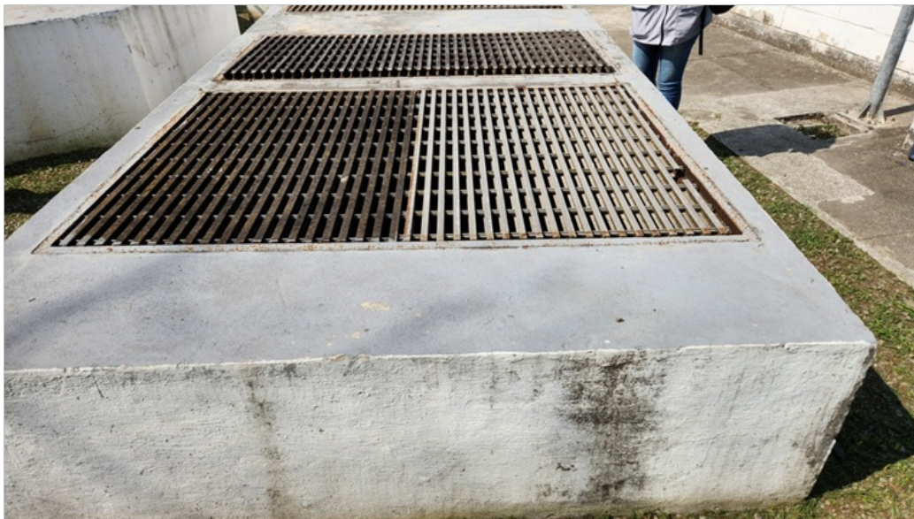
Foto 2 – Barrilete de recirculação desativado
