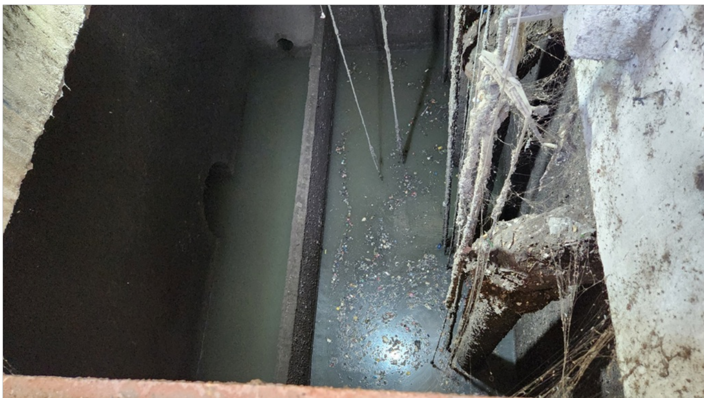
Foto 8 – Poço de sucção onde estão localizados os conjuntos motobombas submersíveis.
