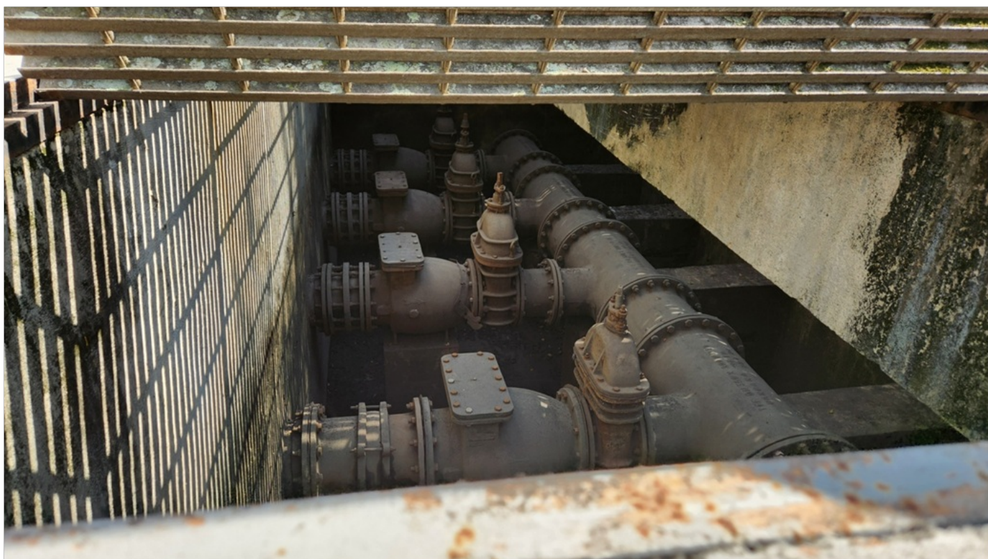
Foto 10 – Barrilete de recalque
