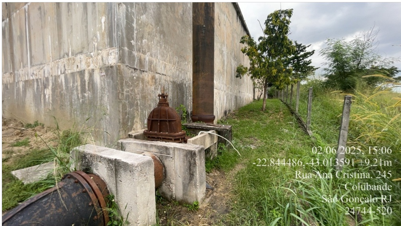
Foto 3 – Tubulação com válvula controladora de nível
