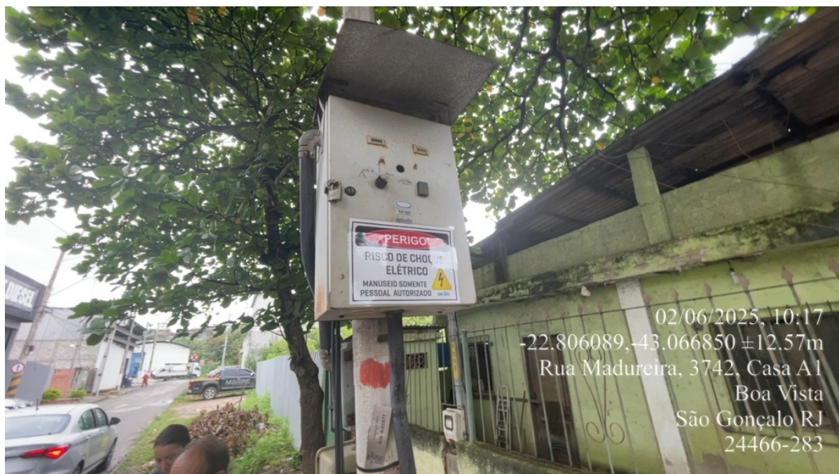
Foto 3 – Paineis das motobombas
