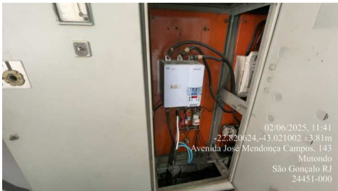
Foto 6 – Vista interna do painel elétrico da EEE
