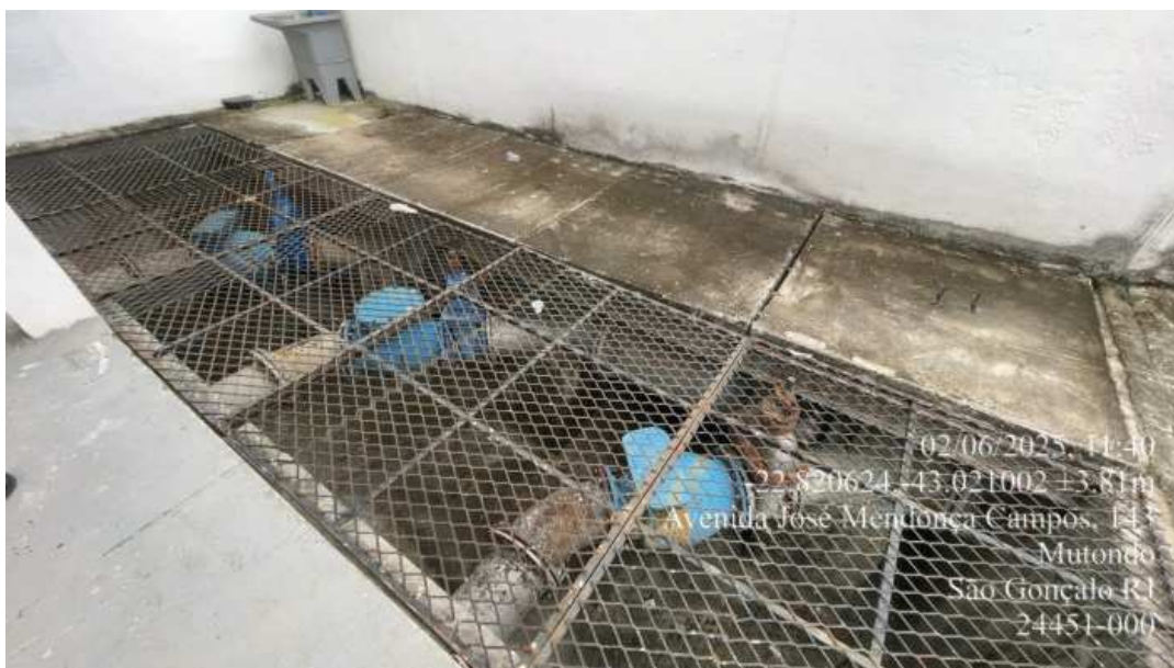
Foto 5 – Caixa de válvulas
