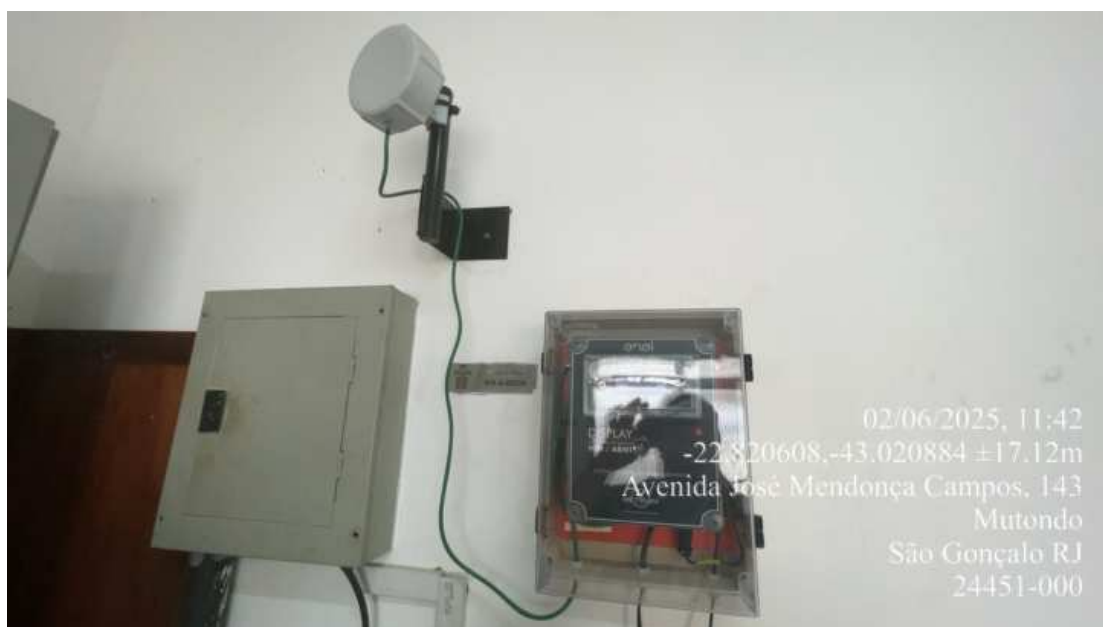
Foto 7 – Sistema de Medição de Faturamento (SMF) com telemetria
