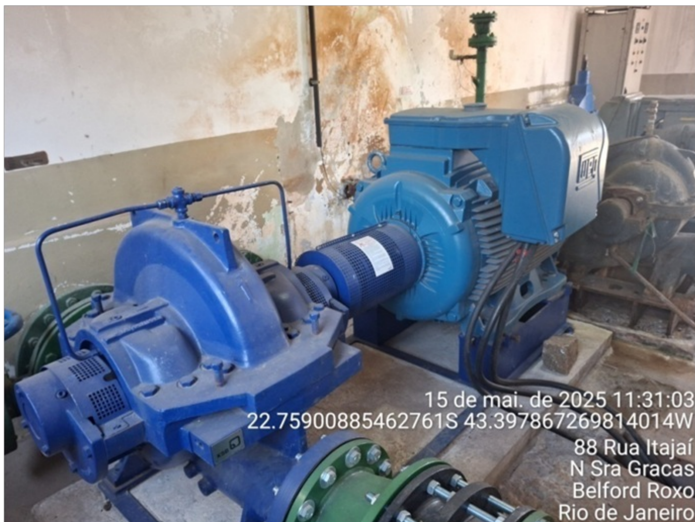
Foto 7 – Conjunto motobomba reserva
