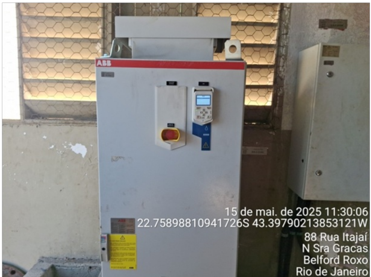
Foto 12 – Inversor de frequência
