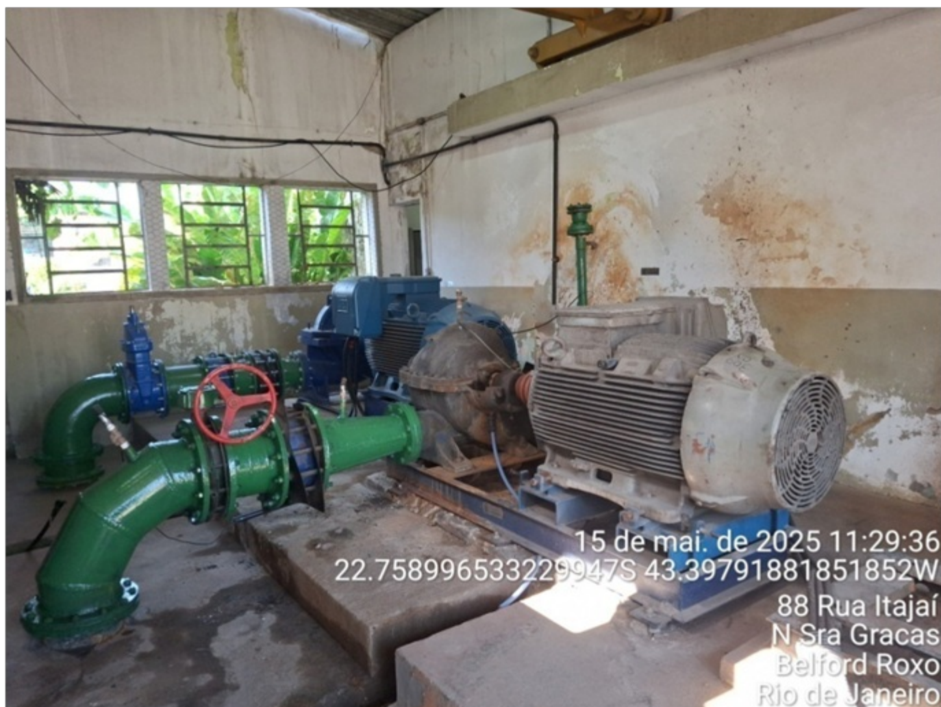
Foto 6 – Conjunto motobomba operante
