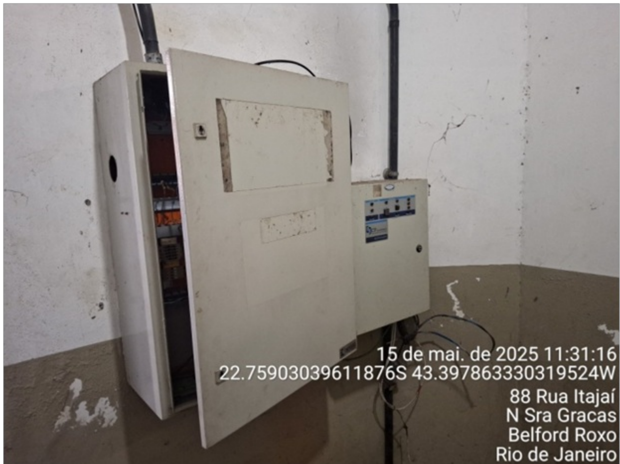
Foto 10 – Painéis de elétrica sem devidas sinalizações de risco
