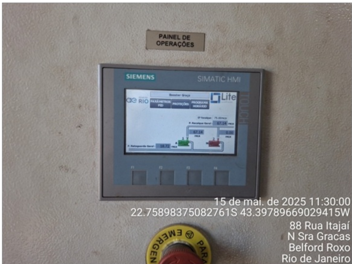
Foto 11 – PAINEL de operação
