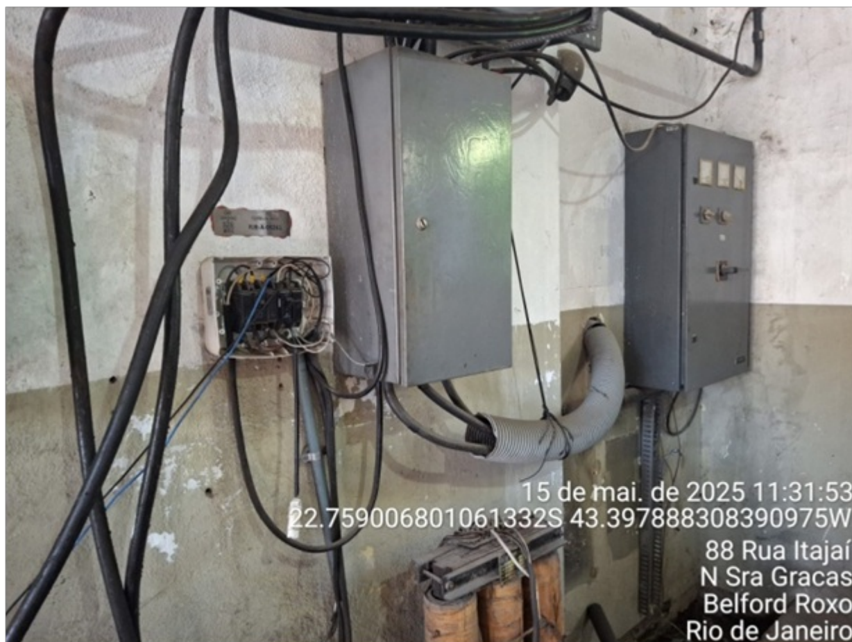
Foto 9 – Painéis de elétrica
