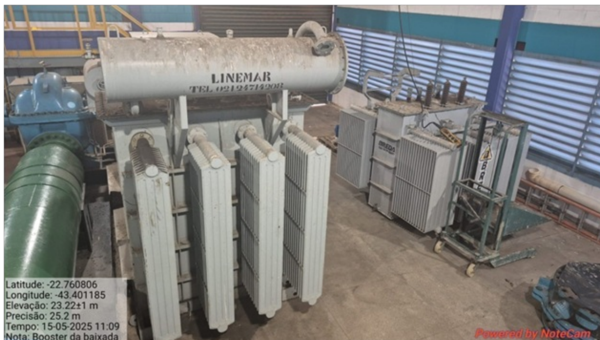
Foto 9 – Transformadores inoperantes armazenados área interna abrigo
