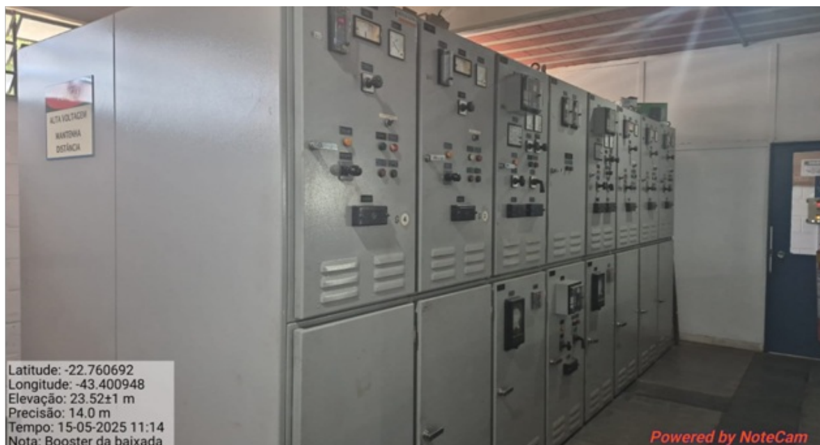
Foto 11 – Painéis de elétrica
