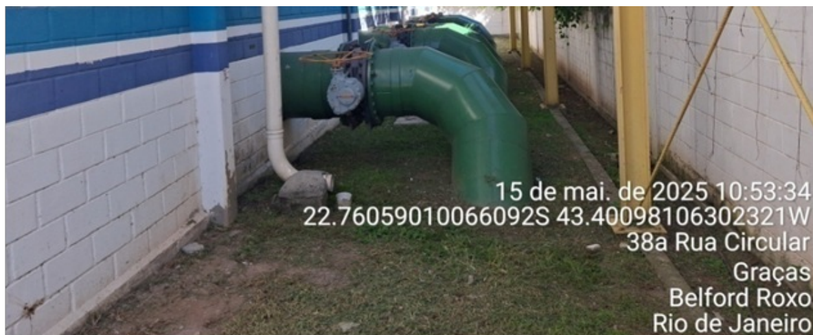
Foto 4 – Barrilete de recalque
