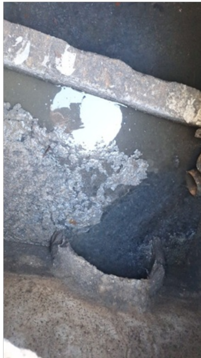
Fotos 4 – CTS da Rua Bernardo Lenz x Av. da Liberdade
