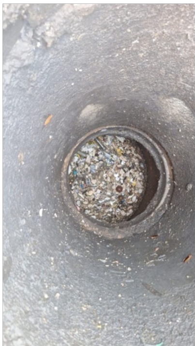
Foto 7 – PV cheio de lixo da Av. Benjamin Constant
