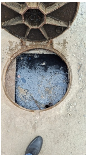
Foto 5 – Poço da EEE cheio pela vazão reduzida do motor, impactando toda rede de esgoto a montante.
