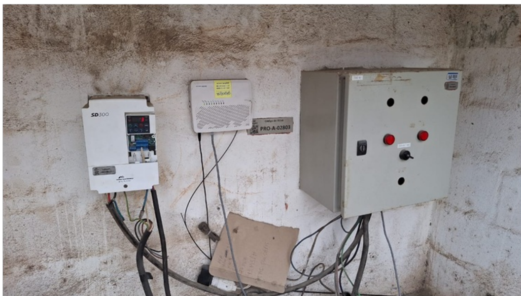
Foto 3 – Quadro elétrico da EEE Monte Alto 2 com proteção, inversor de frequência, telemetria.
