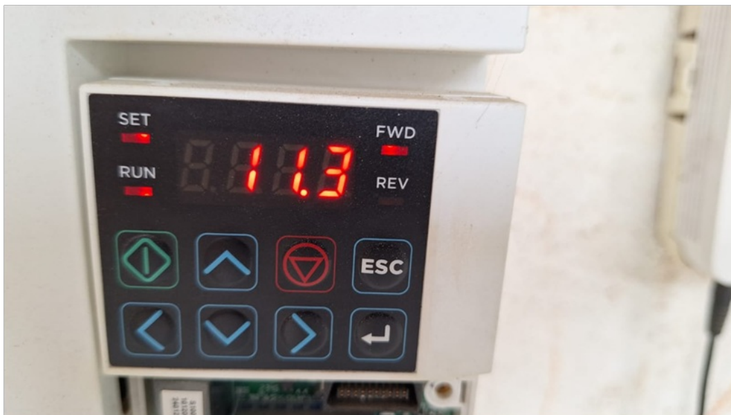
Foto 5 – Amperagem da bomba 11,3 A .
