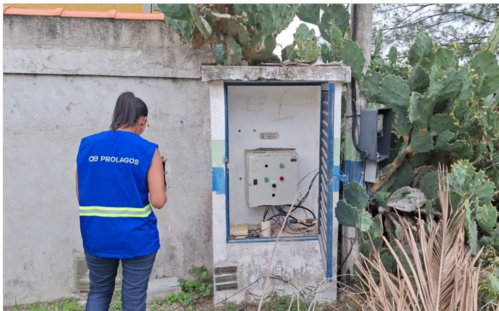
Foto 2 – Vista do Quadro da EEE Monte Alto 1
