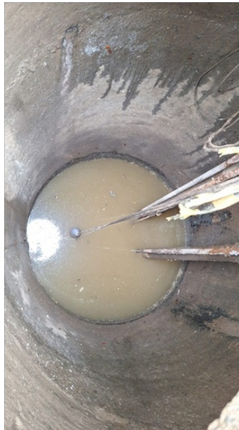
Foto – Poço da EEE com um conjunto moto-bomba .
