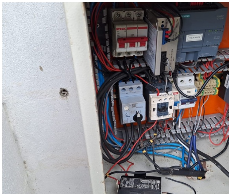
Foto 3 – Quadro elétrico da EEE Monte Alto 1 com proteção, inversor de frequência, telemetria.
