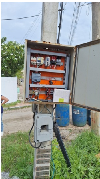
Foto 3 – Quadro elétrico da EEE Monte Alto 4 com proteção e telemetria.
