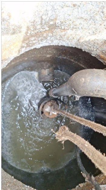
Foto 4 – Poço da EEE com um conjunto moto-bomba .
