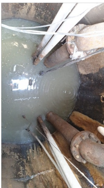
Foto 6 – Poço da EEE .
