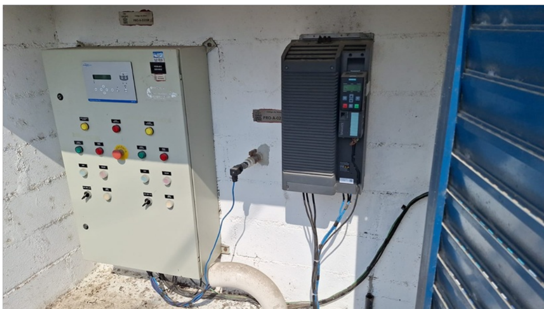
Foto 3 – Quadro elétrico da EEE com inversor de frequência e
