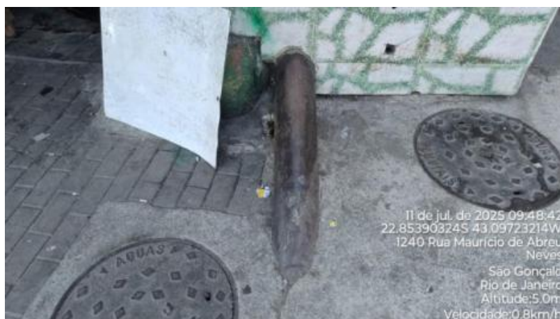
Foto 09 – Tubulação sobressalente no passeio
