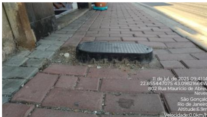
Foto 05 – Caixa de proteção fora do padrão estabelecido
