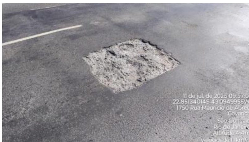
Foto 10 – Intervenção sem recomposição adequada
