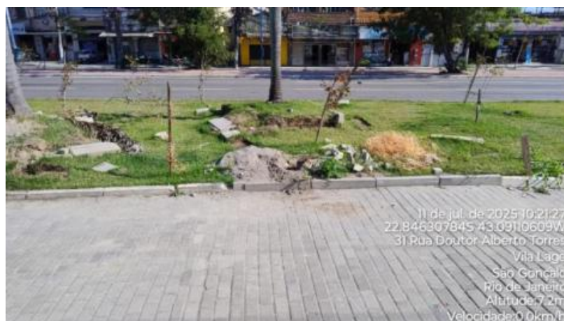
Foto 12 – Canteiro Inacabado após intervenção em tubulação sob responsabilidade da CEDAE
