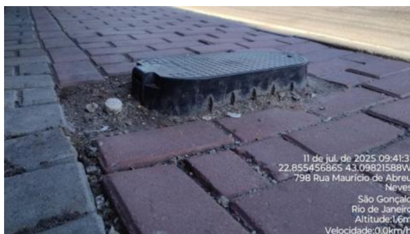
Foto 06 - Caixa de proteção fora do padrão estabelecido
