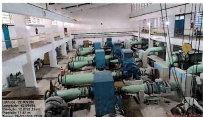
Foto 78: Conjuntos motobombas da elevatória 1.
