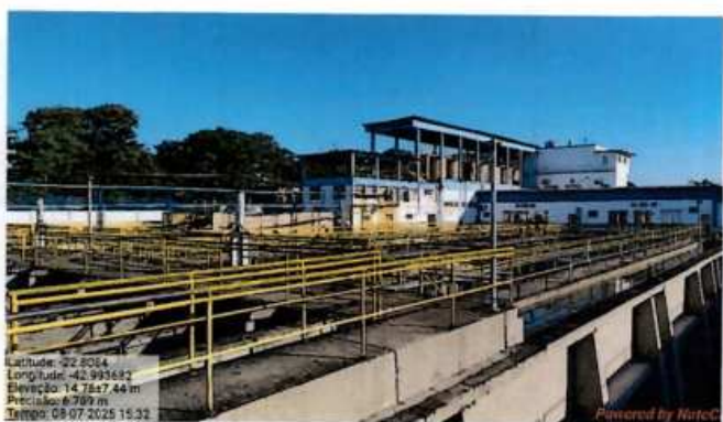
Foto 43: Vista da ETA 2.
