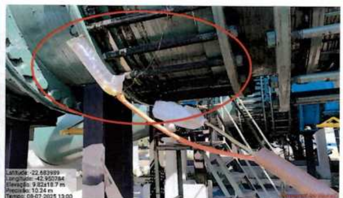
Foto 22: Ponto de vazamento.
