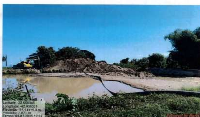
Foto 14: Armazenamento do material dragado.
