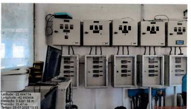
Foto 26: Painéis elétricos dos CMB.
