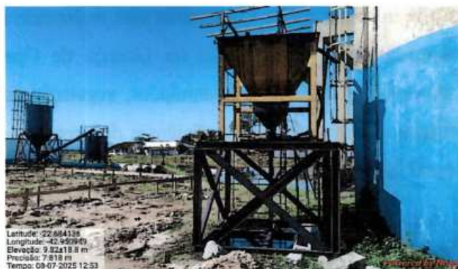
Foto 18: Unidade de carvão ativado em stand-by.
