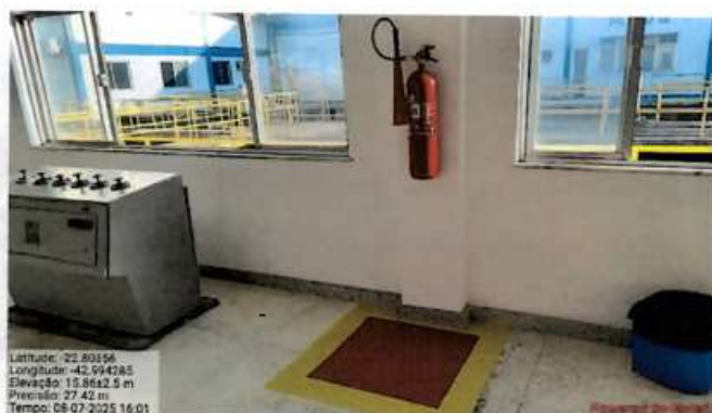
Foto 35: Extintor de incêndio.
