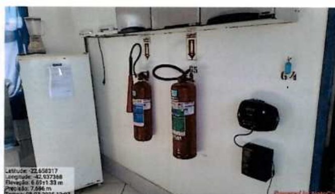
Foto 12: extintores de incêndio.
