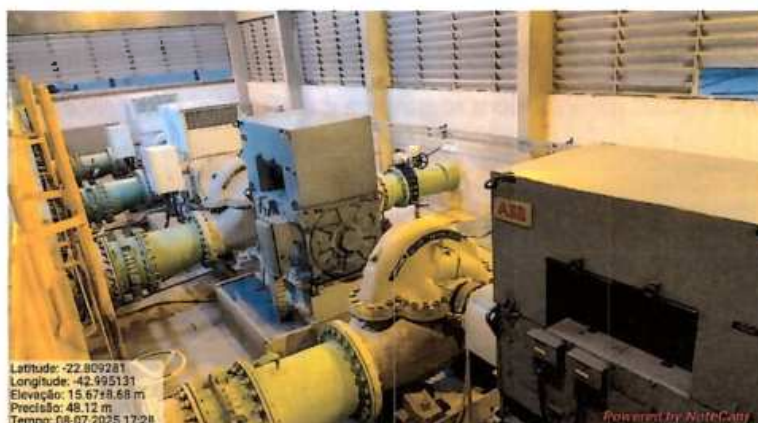
Foto 80: Conjuntos motobombas da elevatória 2.
