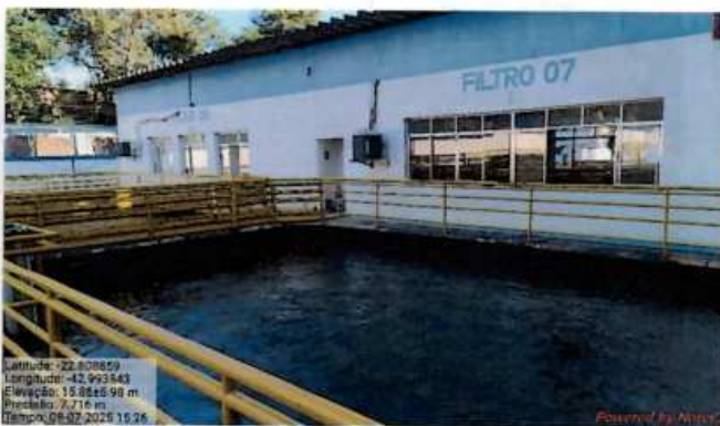
Foto 42: Filtros da ETA 1 operando em boas condições.
