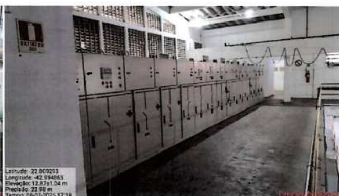
Foto 79: Paineis elétricos da elevatória 1.
