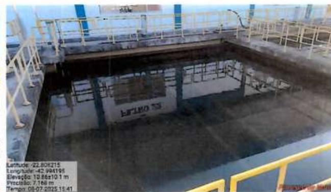
Foto 50: Filtros da ETA 3 operando em boas condições.
