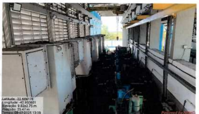
Foto 24: Conjunto motobombas da EEAB.
