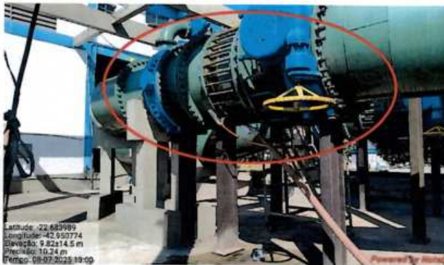
Foto 21: Ponto de vazamento.
