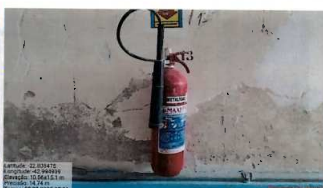
Foto 36: Extintor de incêndio.
