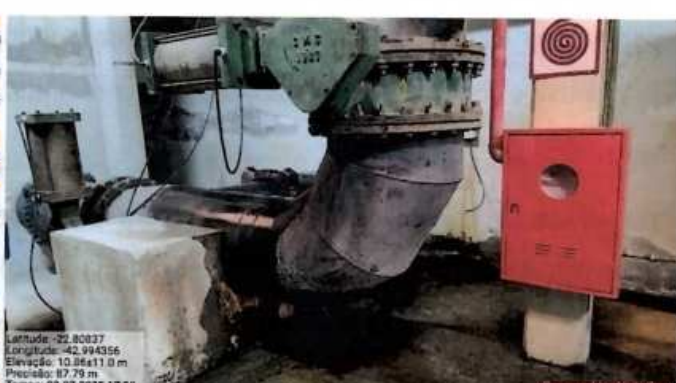
Foto 34: caixa de hidrante.
