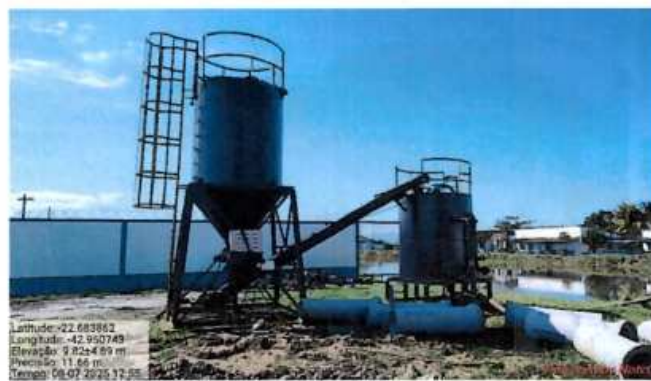
Foto 19: Unidade de carvão ativado automatizada.
