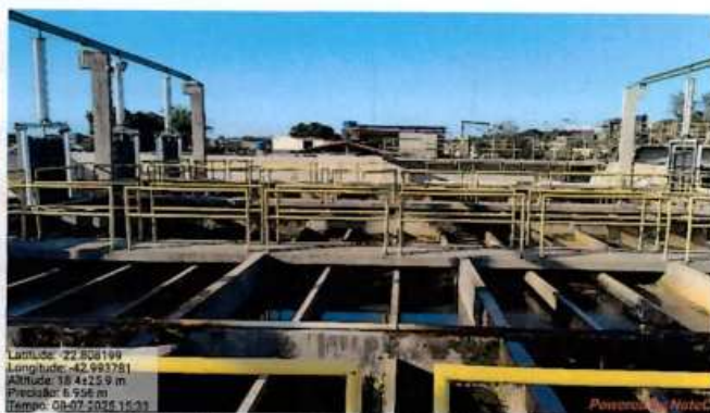
Foto 44: Floculadores da ETA 2 operando em boas condições.
