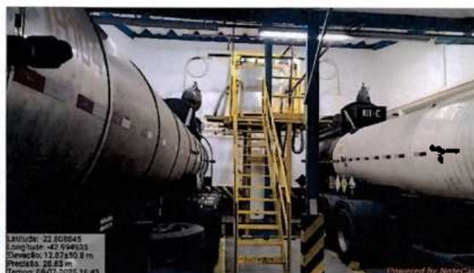
Foto 60: Cilindros de cloro líquido (exaustor ao fundo).
