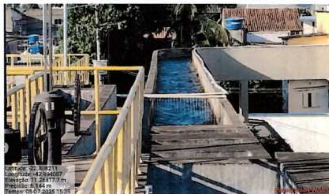
Foto 46: Entrada de água bruta na ETA 3.
