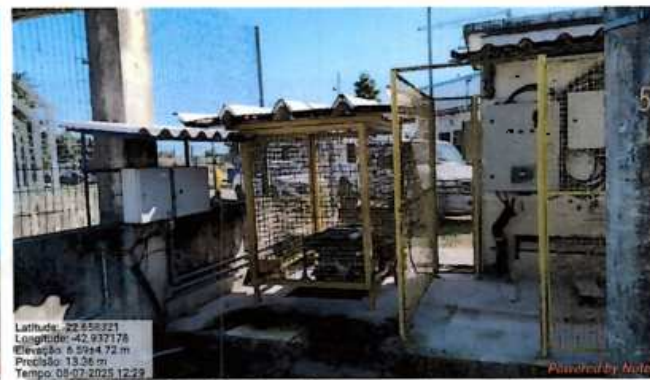
Foto 10: gerador de energia.
