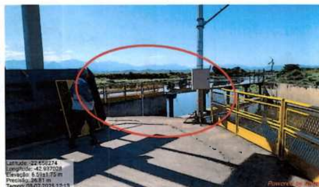
Foto 8: Trecho com ausência de guarda-corpo.
