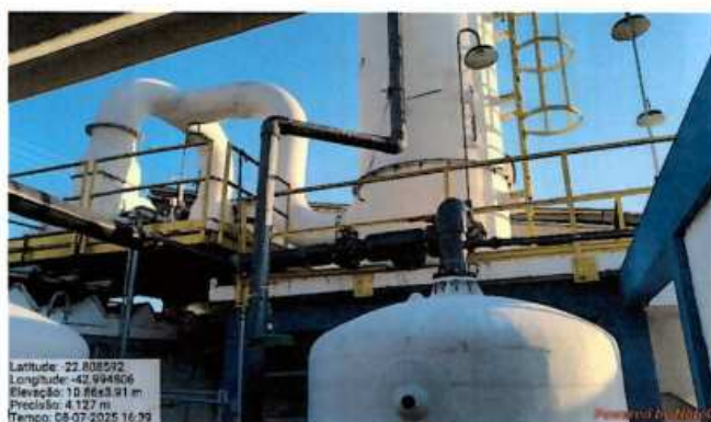
Foto 66: sistema de neutralização de cloro.
