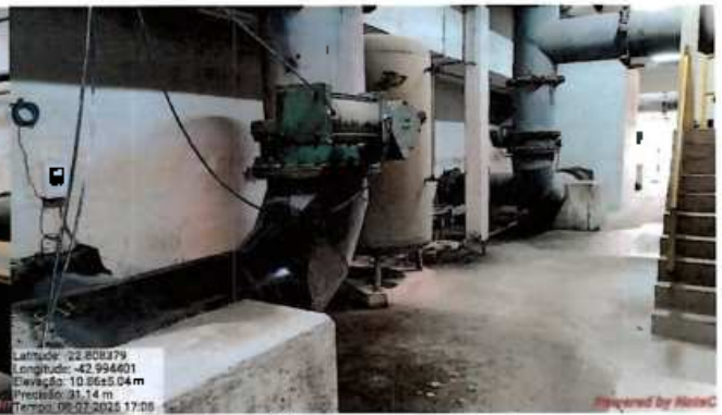
Foto 58: Galeria de filtros necessitando de obras (parte inferior).
