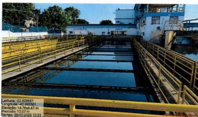
Foto 41: Decantadores da ETA 1 operando em boas condições.
