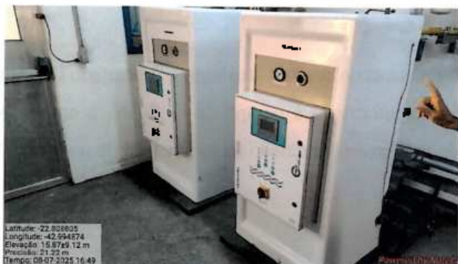
Foto 63: Evaporadores de cloro.
