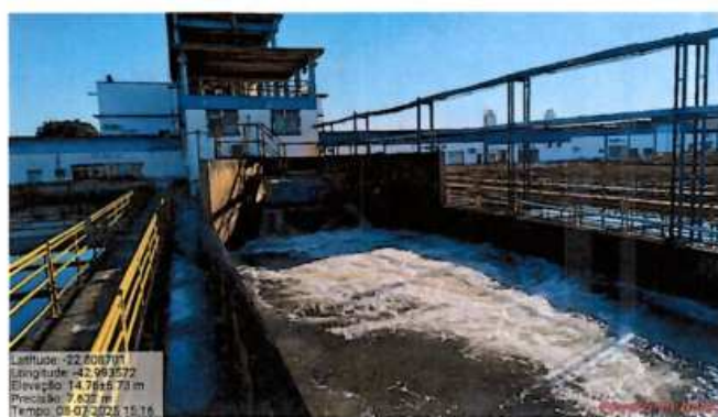
Foto 37: Entrada de água bruta na ETA 1.
