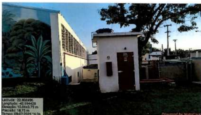
Foto 31: Casa de bomba de combate a incêndio, recentemente instalada.
