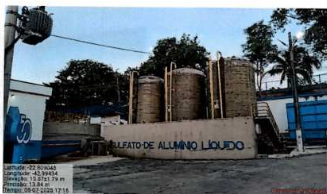
Foto 69: Tanques de armazenamento de sulfato de alumínio.
