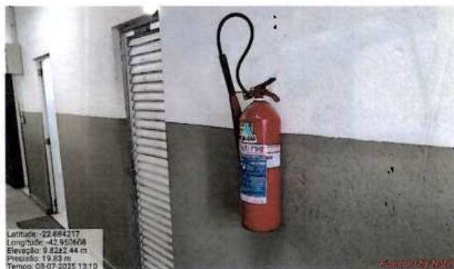
Foto 28: Extintor de incêndio.
