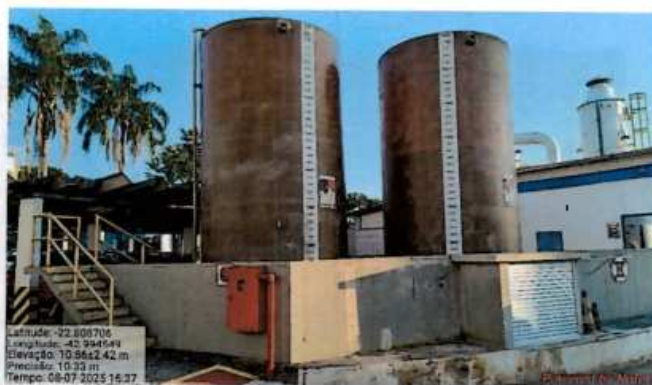
Foto 70: Tanques de armazenamento de ácido fluossilícico.
