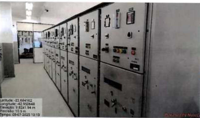
Foto 25: Painéis elétricos dos CMB.
