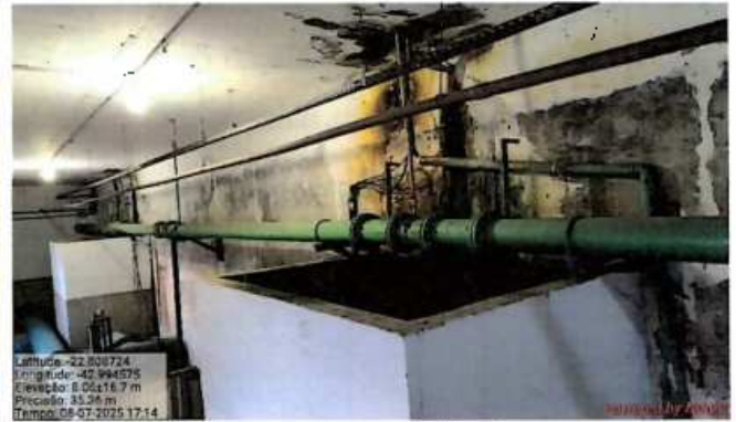
Foto 56: Galeria de filtros necessitando de obras (parte inferior).
