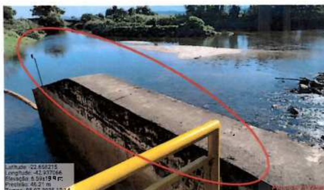
Foto 7: Trecho com ausência de guarda-corpo.
