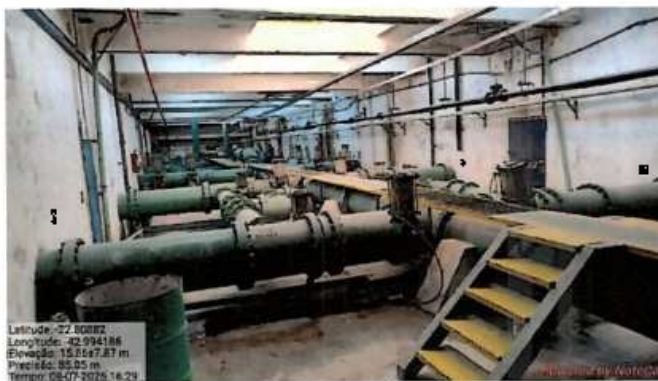
Foto 57: Galeria de filtros necessitando de obras (parte inferior).
