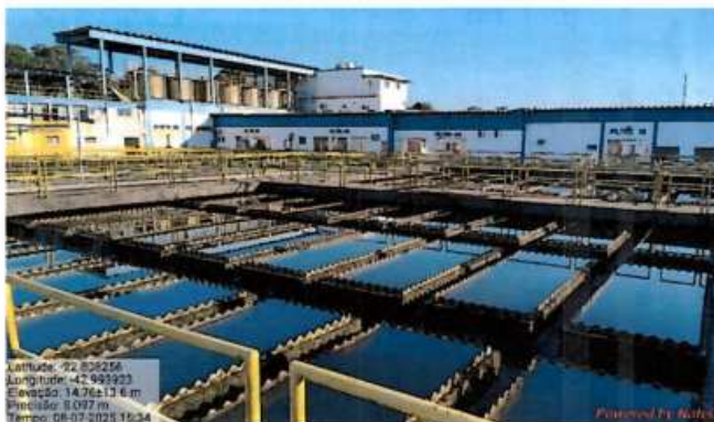
Foto 45: Decantadores da ETA 2 operando em boas condições.
