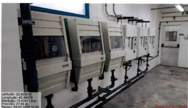
Foto 64: Dosadores de cloro.
