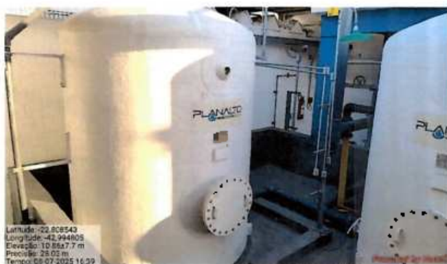
Foto 65: Tanques de armazenamento hidróxido de sódio.
