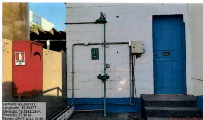
Foto 59: Entrada da área de cloração com chuveiro lava olhos instalado.
