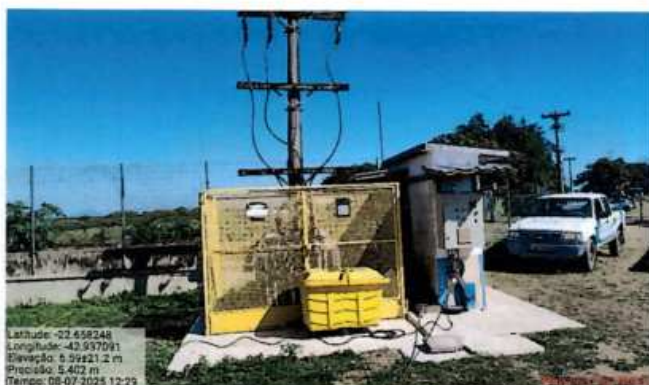
Foto 11: Transformador da unidade.
