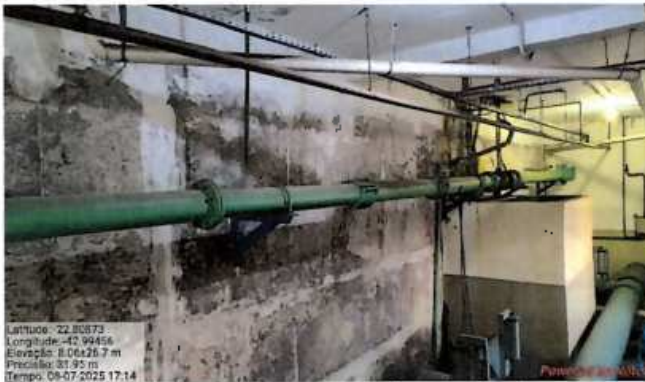
Foto 55: Galeria de filtros necessitando de obras (parte inferior).
