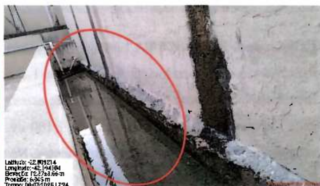
Foto 82: Vazamento de água do tanque de contato.
