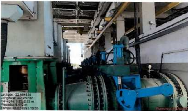
Foto 23: Conjunto motobombas da EEAB.
