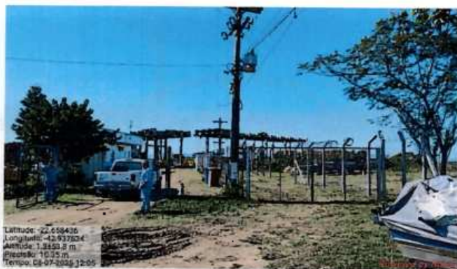
Foto 1: Entrada unidade de captação (ausência de placa de identificação).
