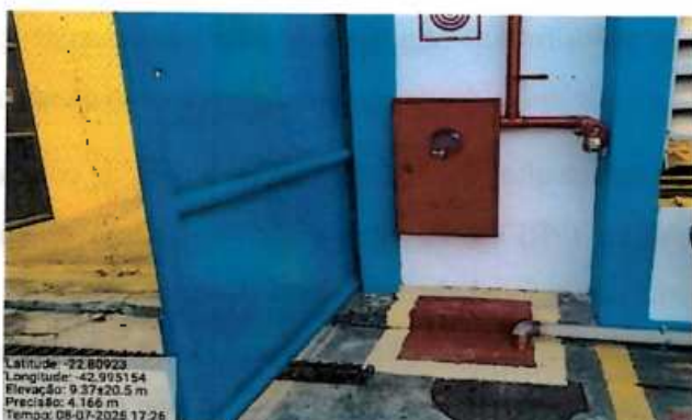
Foto 33: caixa de hidrante.
