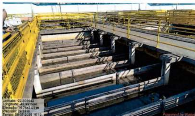
Foto 40: Floculadores operando em boas condições.
