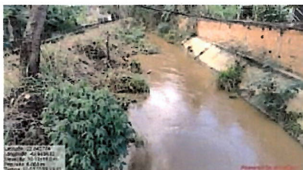
Foto 9: Vista a jusante do canal novo, observou-se, além da extensa vegetação, danos na estrutura do canal (trincas e rachaduras).
