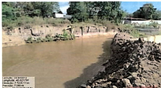
Foto 19: Constatou-se que houve um alargamento no desvio após o transbordamento do canal.
