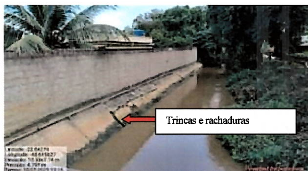
Foto 11: Vista a montante do canal novo, observou-se, além da extensa vegetação, danos na estrutura do canal (trincas e rachaduras).
