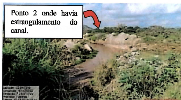
Foto 26: Observou-se que houve intervenção no canal, após transbordamento, para melhorar o fluxo e a vazão.
