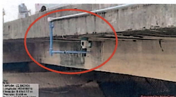
Foto 6: Detalhe do monitoramento do nível do canal através de sensor de nível.
