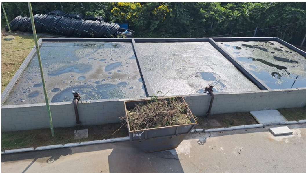
Foto 14 – Leito de secagem do lodo que tem destino em aterro sanitário.
