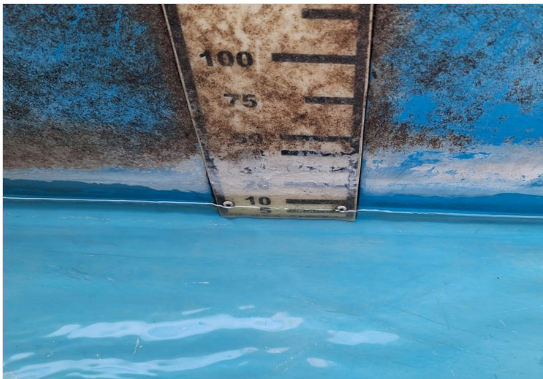
Foto 10 –Régua da calha parchall do efluente tratado indicando uma vazão ente 5 e 10 l/s ~ 7,5 l/s .
