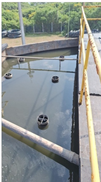
Foto 8 – Reator Anaeróbio/Anóxico de fluxo ascendente. As passarelas sobre o tanque estão com madeirite em substituição as chapas de aço; e guarda-corpos estão com corrosão pela maresia e pelos gases de unidades de esgoto. O tanque metálico foi revestido internamente com impermeabilização a base de fibra de vidro e resina devido a corrosão.
