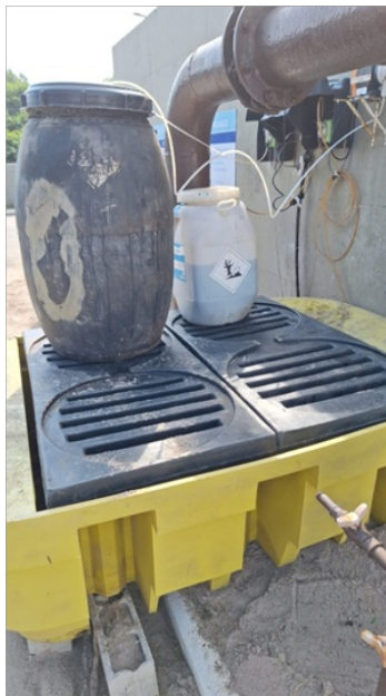
Foto 12 – Dosadores de produtos químicos e baia de contenção das bombonas de hipoclorito de sódio.
