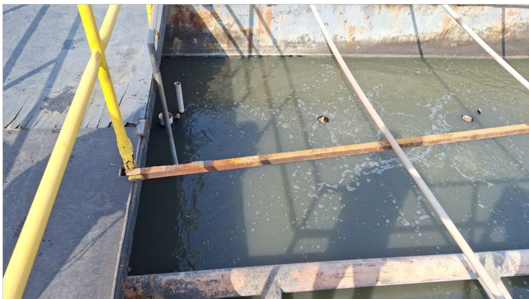
Foto 9 – Dosagem de PAC para floculação.
