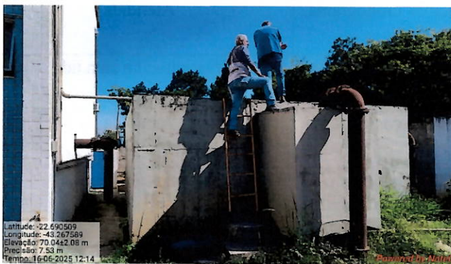
Foto 33: Tanque de recebimento de lodo.
