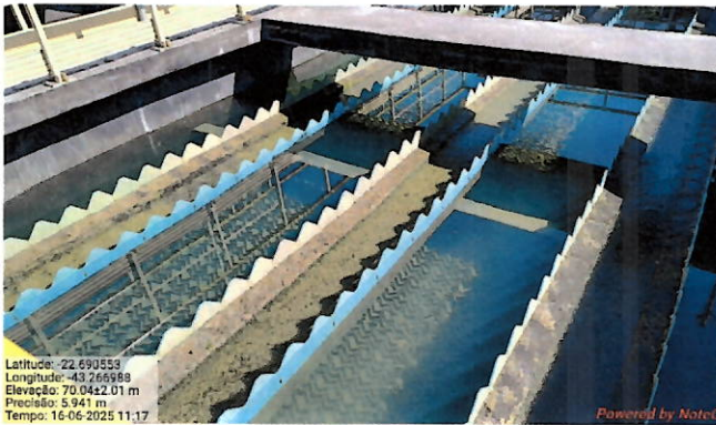
Foto 12: Decantadores operando em boas condições.
