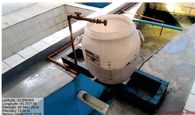
Foto 7: Aplicação de coagulante Sulfato de Alumínio.
