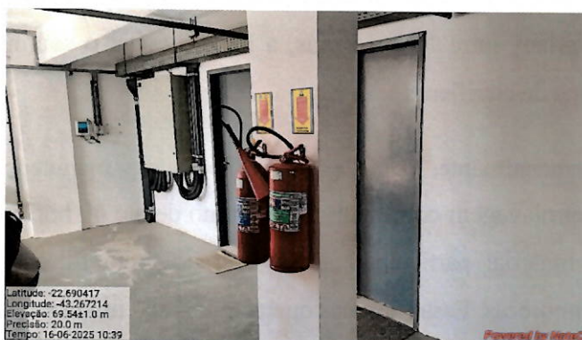
Foto 2: Extintores de incêndio em diferentes pontos.
