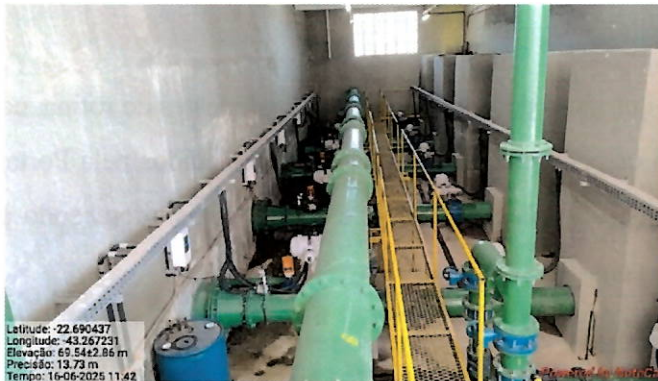
Foto 18: Galeria de filtros.
