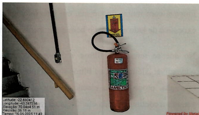
Foto 3: Extintores de incêndio em diferentes pontos.
