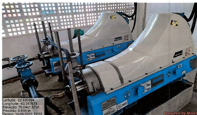
Foto 36: Centrífuga utilizada para desidratação do lodo
