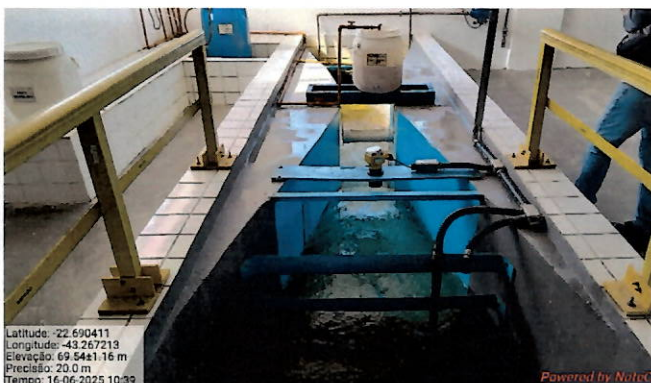
Foto 6: Entrada de água bruta no sistema.
