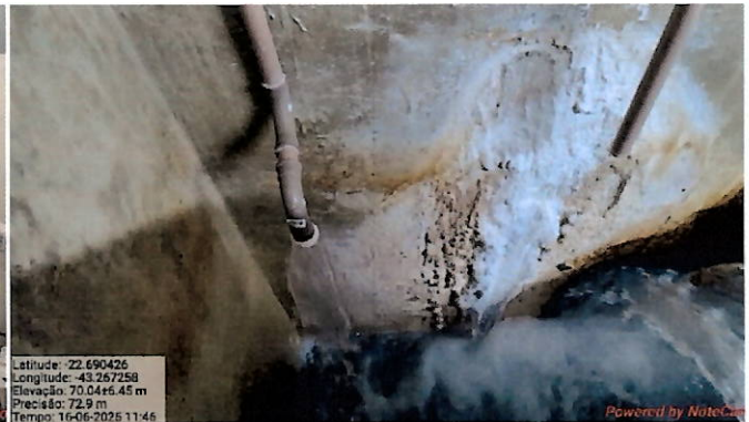
Foto 19: Ponto de aplicação de Hipoclorito de Cálcio.
