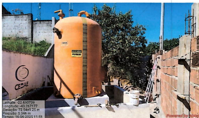
Foto 29: Armazenamento de peróxido de hidrogênio.
