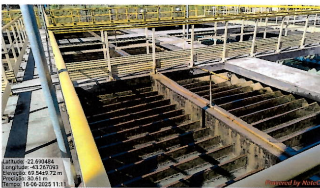
Foto 10: Floculadores operando em boas condições.
