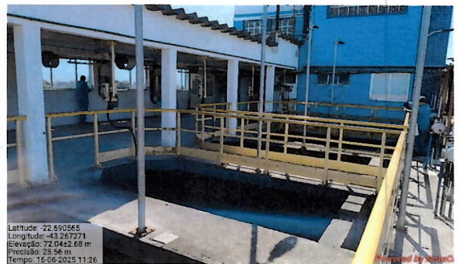
Foto 13: Vista dos filtros.
