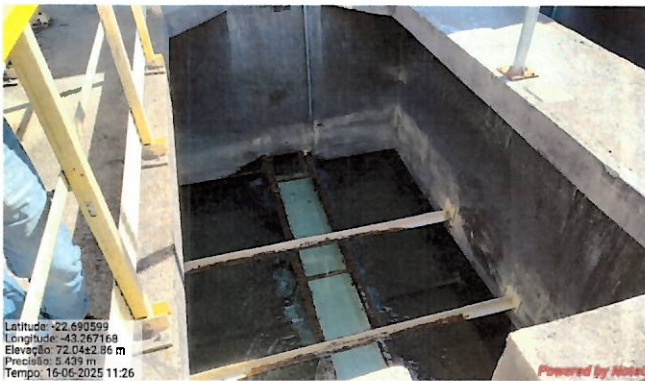
Foto 14: filtros operando em boas condições.
