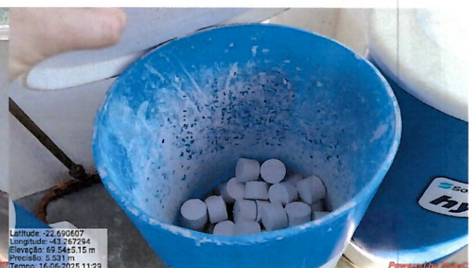
Foto 17: Sistema de cloração com Hipoclorito de Cálcio.
