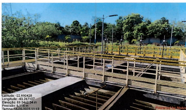
Foto 9: Vista dos floculadores.
