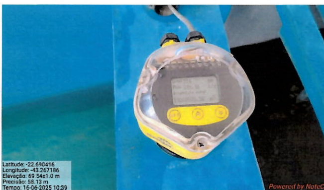
Foto 8: Medidor de vazão automático.
