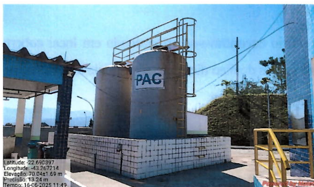
Foto 28: Armazenamento de sulfato de alumínio.
