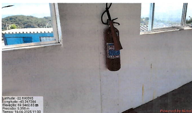
Foto 4: Extintores de incêndio em diferentes pontos.
