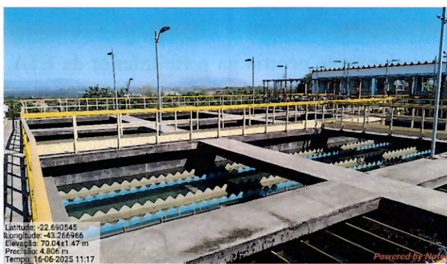
Foto 11: Vista dos decantadores.
