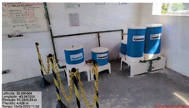
Foto 16: sistema de cloração com Hipoclorito de Cálcio..
