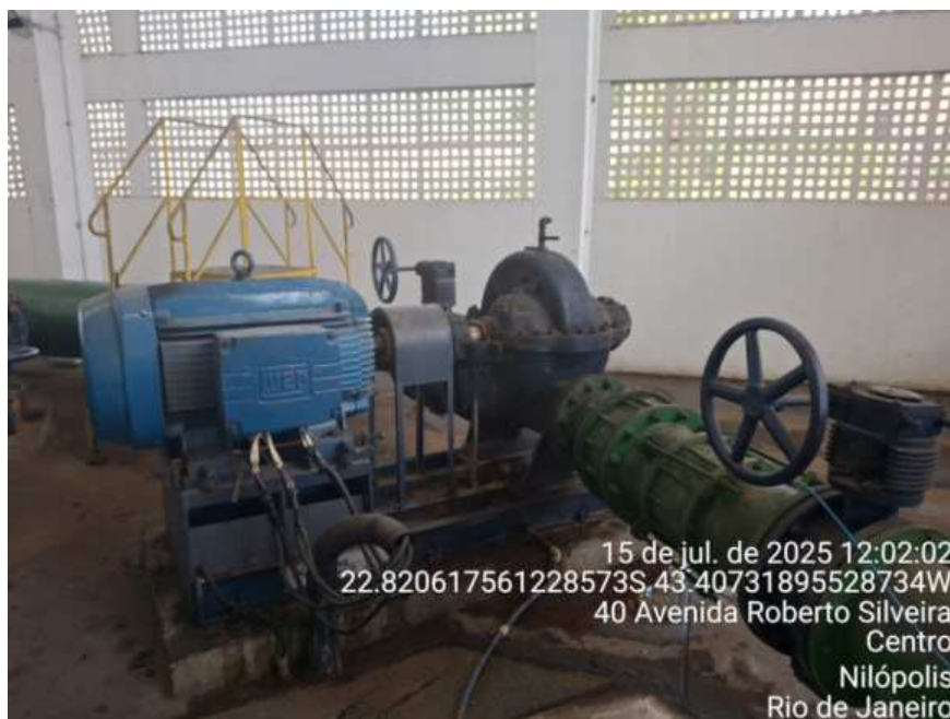
Foto 5. Bomba 3 com vazamento na drenagem de resfriamento.
