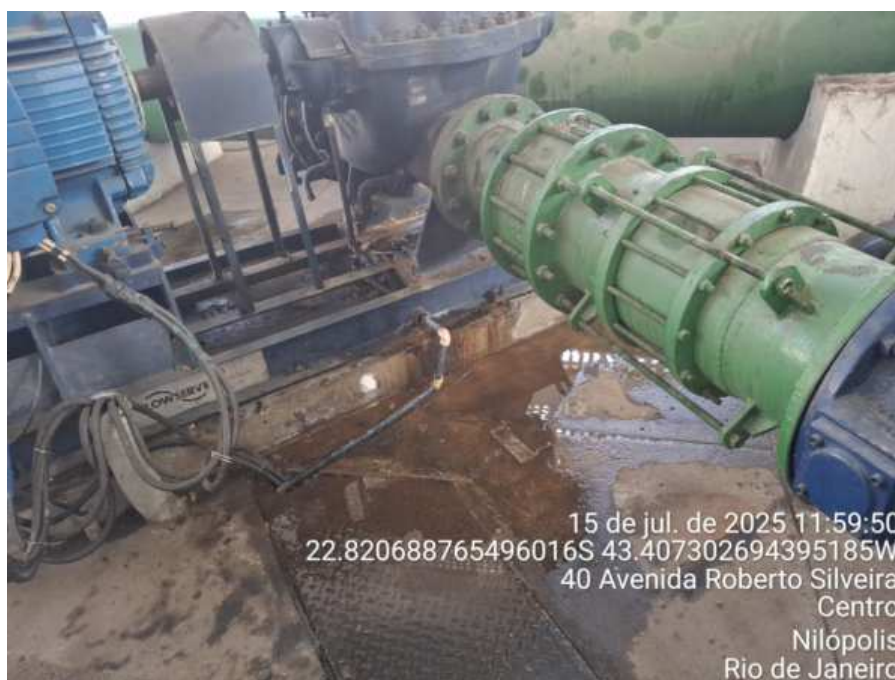
Foto 4. Bomba 1 com vazamento na drenagem de resfriamento.
