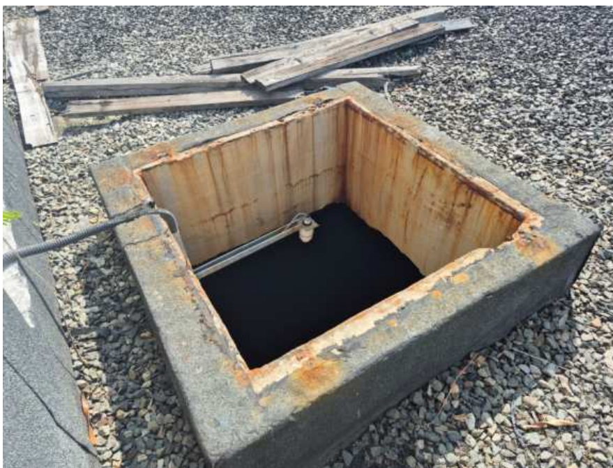
Foto 6. Caixa de visita sem tampa.
