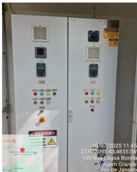
Foto 2 – Painel elétrico da EEEB
