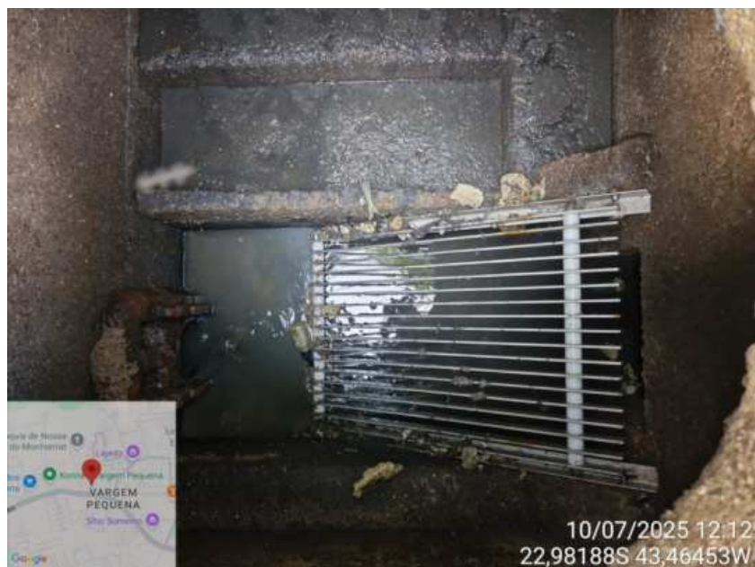
Foto 3 – Caixa de chegada do esgoto com gradeamento
