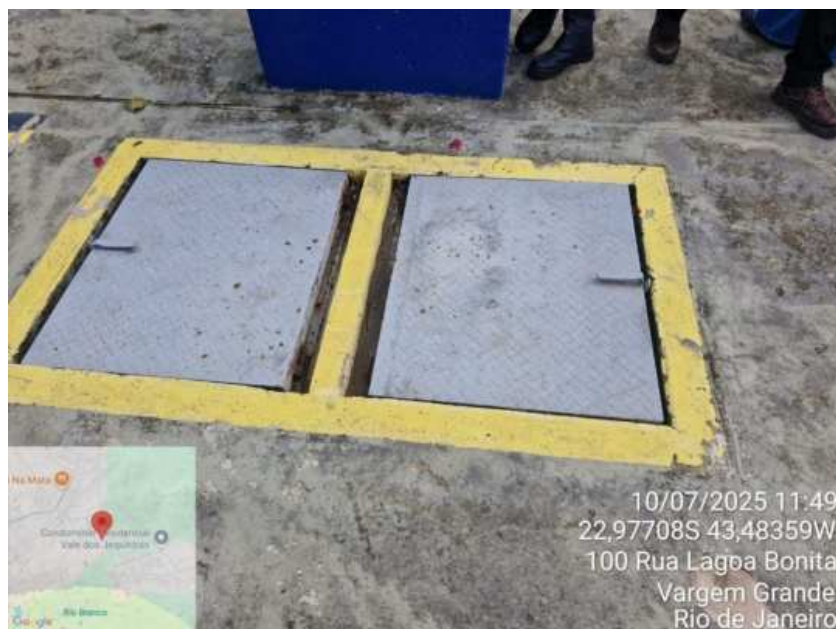
Foto 7 – Tampões do poço das motobombas
