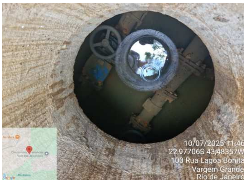
Foto 10 – Tubulações de recalque
