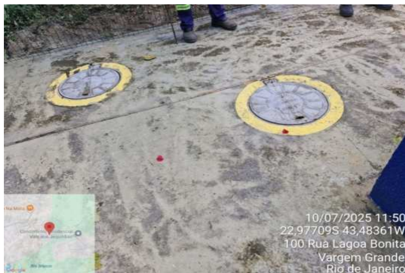
Foto 9 – Tampões do poço das tubulações de recalque
