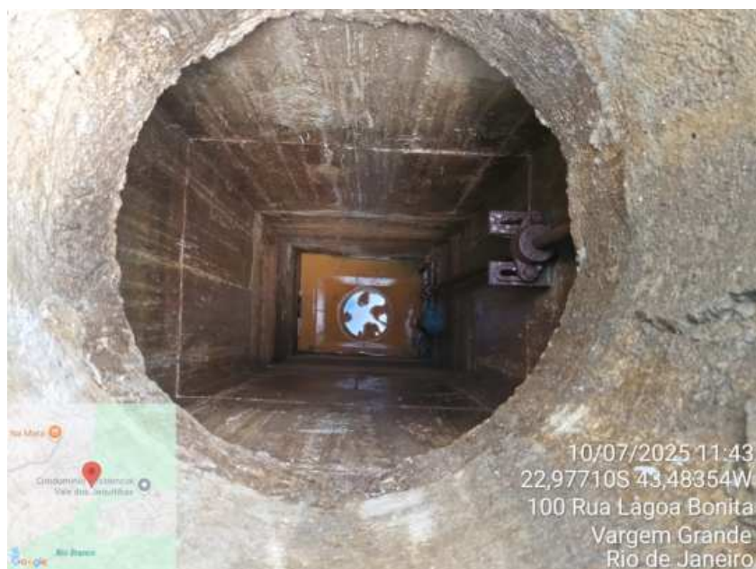
Foto 4 – Caixa de chegada do esgoto com gradeamento
