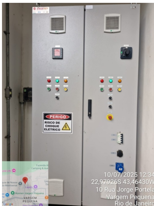
Foto 2 – Painel de controle das motobombas
