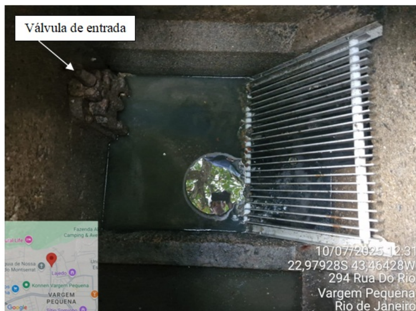
Foto 3 – Caixa receptora do esgoto
