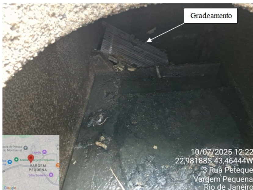
Foto 5 – Caixa receptora do esgoto
