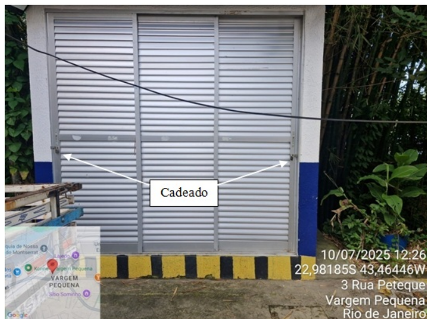
Foto 1 – Abrigo do painel elétrico da EEEB
