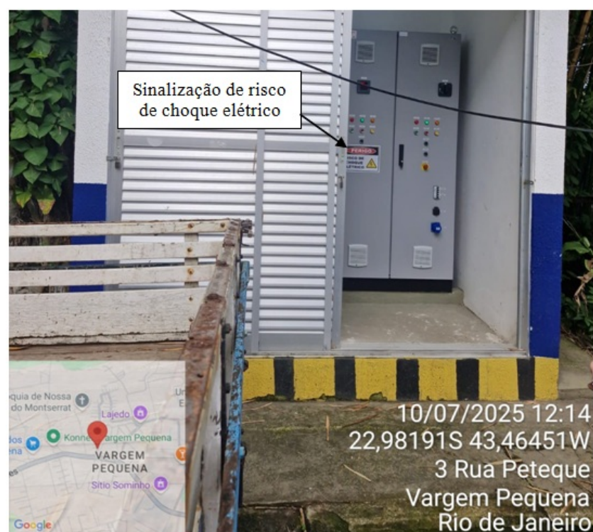
Foto 2 – Painel elétrico da EEEB
