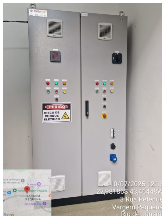
Foto 3 – Painel elétrico da EEEB
