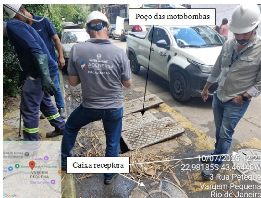
Foto 4 – Poço e caixa receptora
