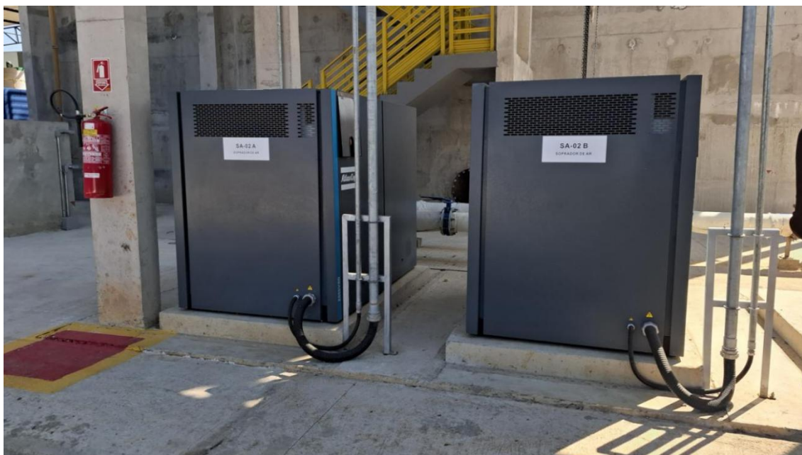
Foto 07 - Sopradores; injetam oxigênio no reator
