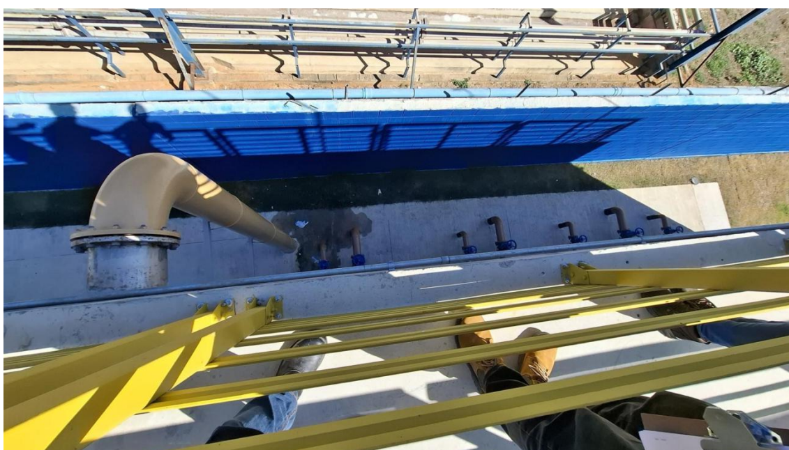
Foto 10 - Tubulações para saída do lodo
