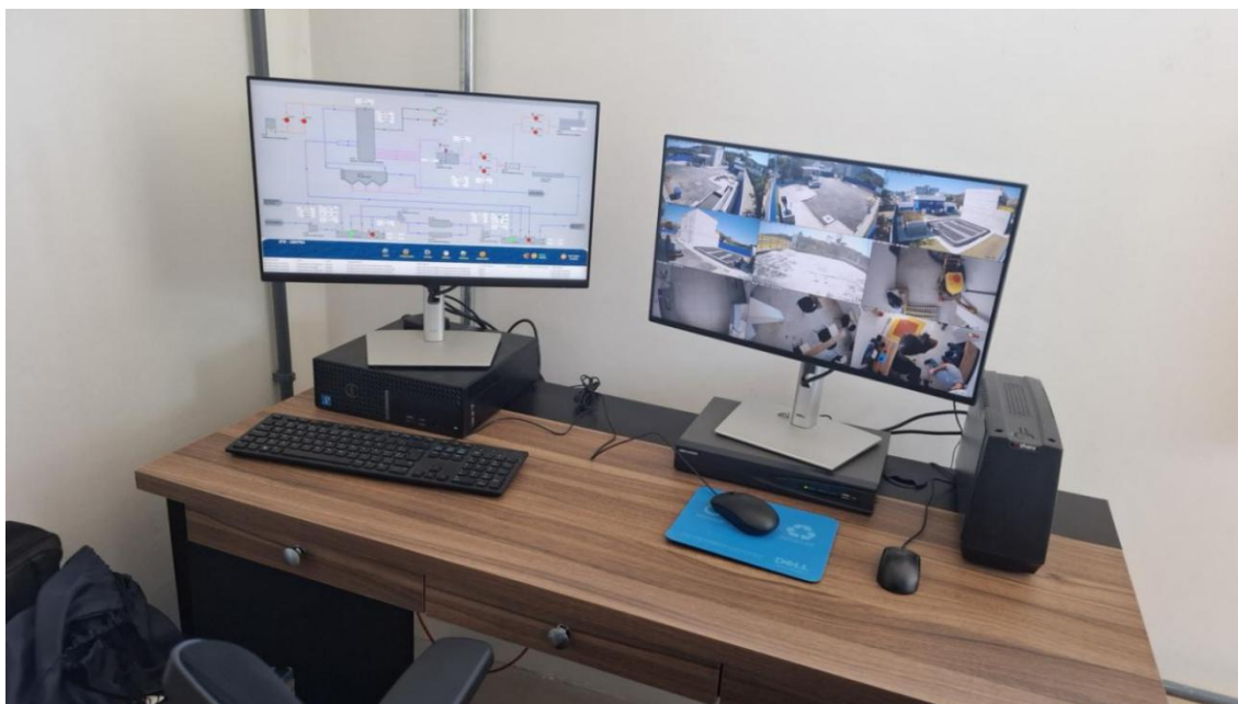
Foto 13 - Mesa de controle operacional
