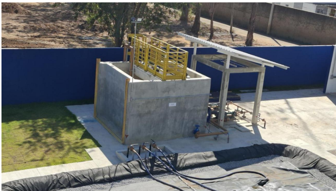
Foto 11 - Tanque de lodo
