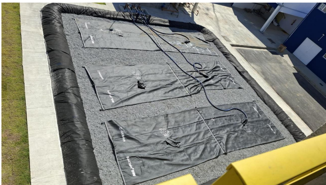
Foto 12 - Geobag; fazem o armazenamento do lodo antes do descarte
