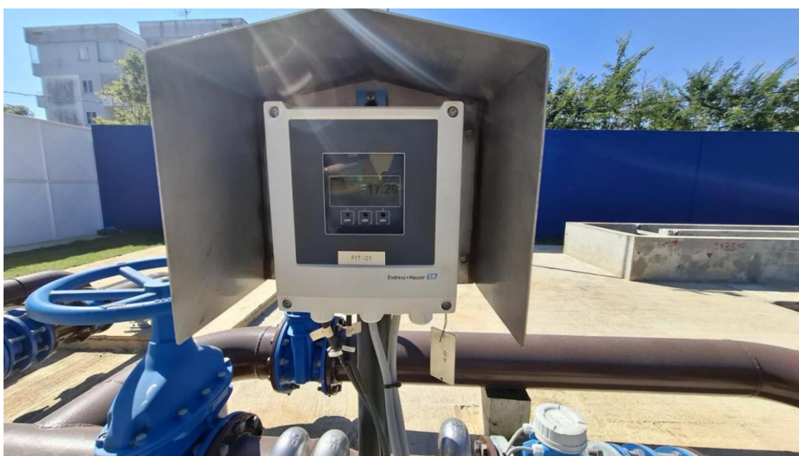
Foto 04 - Macromedidor de entrada; leitura de 17,29 l/s no momento da fiscalização
