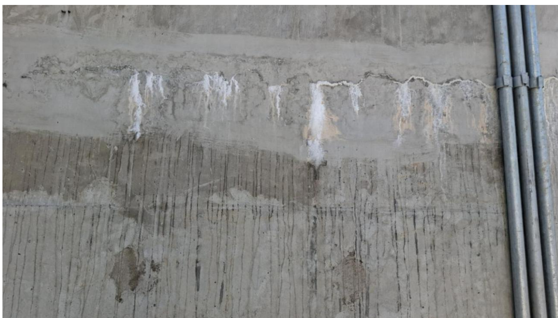
Foto 06 - Pequenos vazamentos estancados por tecnologia presente no material; vazamentos não são indicativos de problemas estruturais
