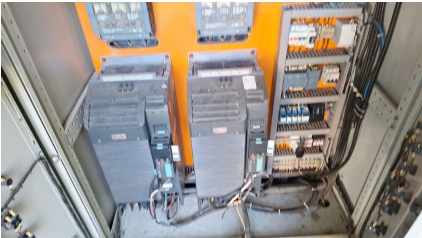
Foto 4 – Quadro elétrico da EEE com inversor de frequência e sistema de botoeiras para acionamento manual .
