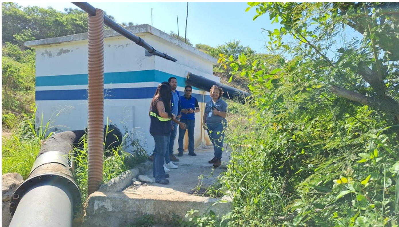
Foto 8 – Caixa de distribuição que recebe três recalques, inclusive da EEE APAE.
