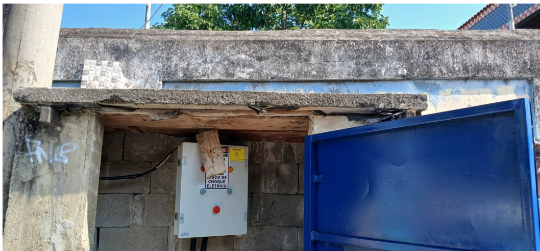
Foto 4 – Condições precárias do teto do abrigo
