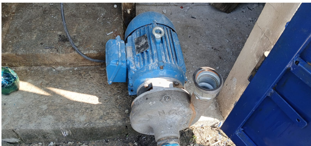
Foto 2 – Conjunto motobomba da unidade
