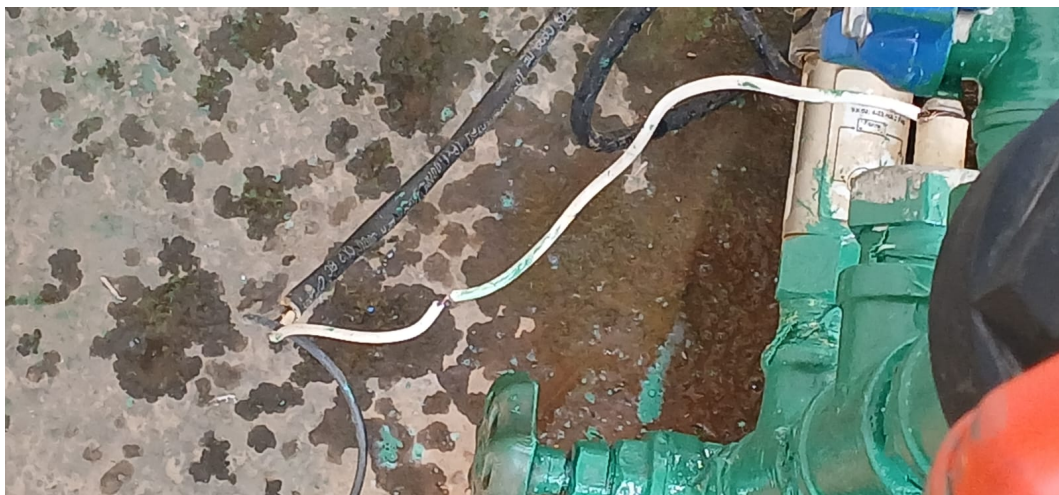
Foto 5 – Fio desemcapado observado próximo ao registro
