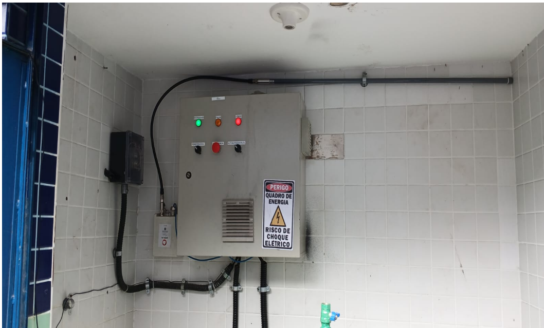
Foto 3 - Painel de automação com sinalização de risco
