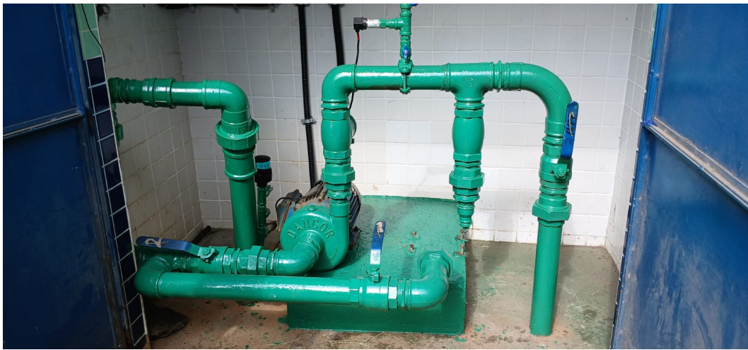
Foto 2 – Conjunto motobomba presente no local
