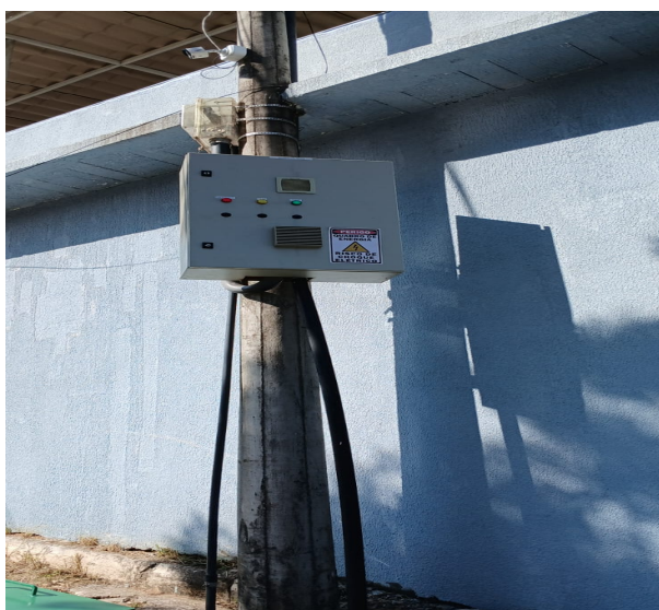
Foto 4 – Pannel de automação com sinalização de risco
