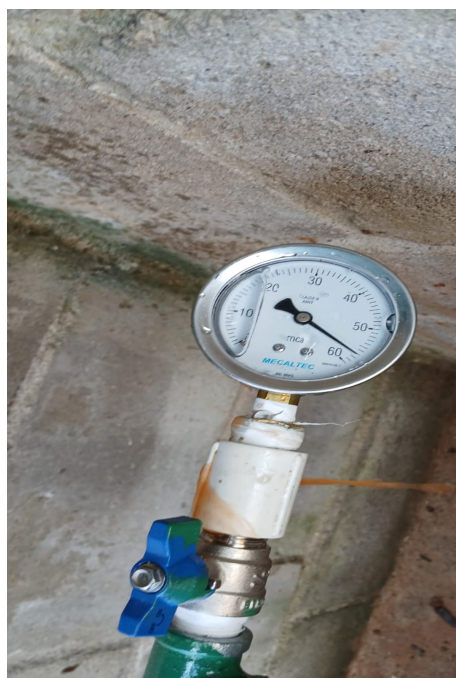
Foto 3 – Pressão de recalque sendo aferida
