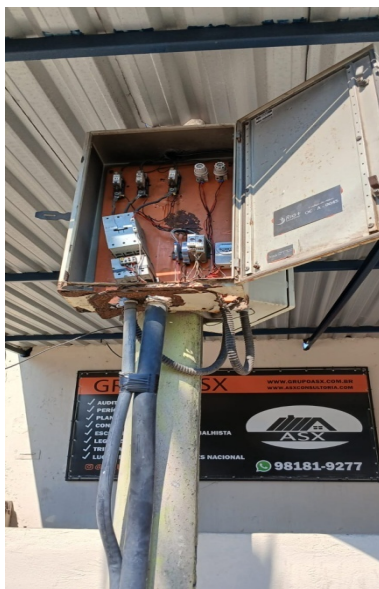
Foto 4 – Painel de automação mau conservado
