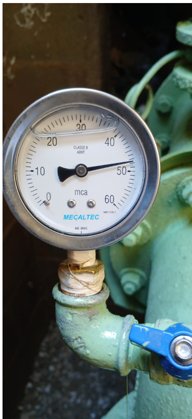
Foto 3 – Pressão de recalque sendo aferida
