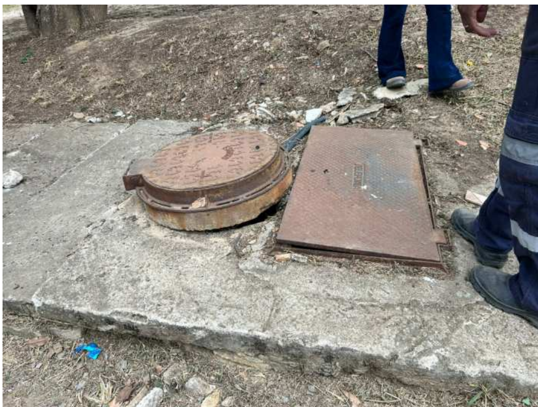
Foto 4 – Poço de sucção onde está instalado o conjunto motobomba
