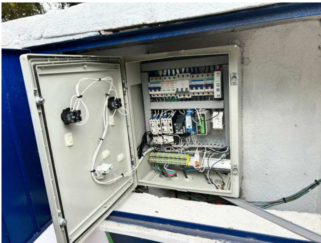
Foto 2 – Abrigo do painel da EEEB
