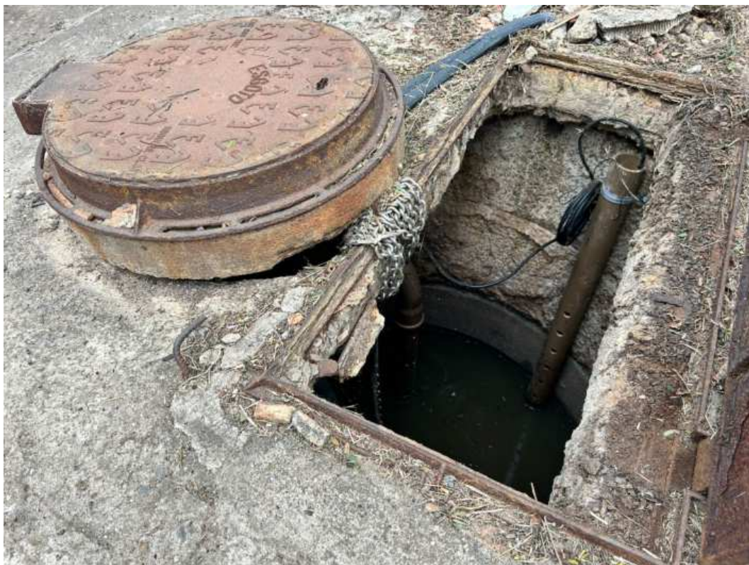
Foto 5 – Poço de sucção onde está instalado o conjunto motobomba
