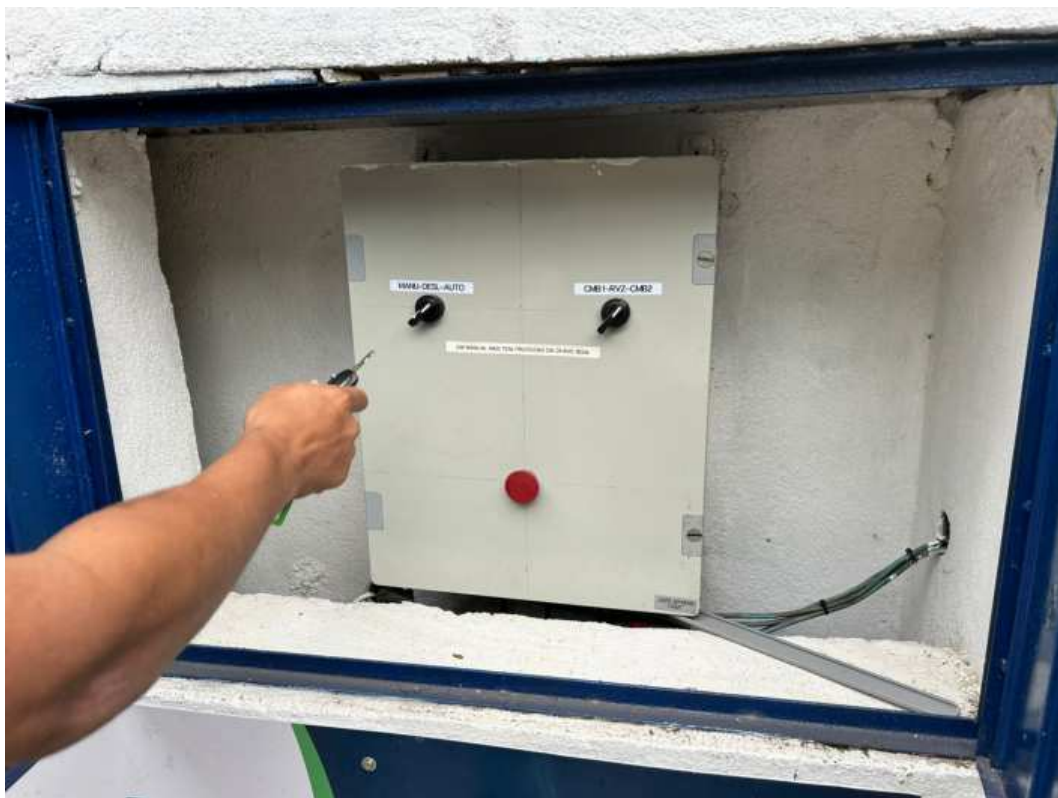
Foto 3 – Pannel da EEEB no abrigo
