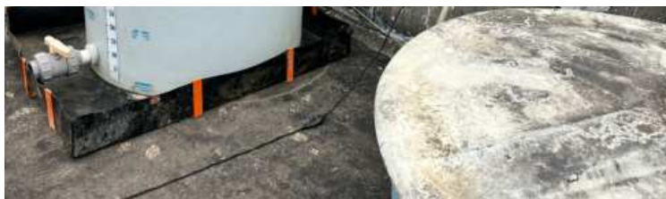
Foto 8 Químico utilizado para correção do PH e auxiliador na floculação
