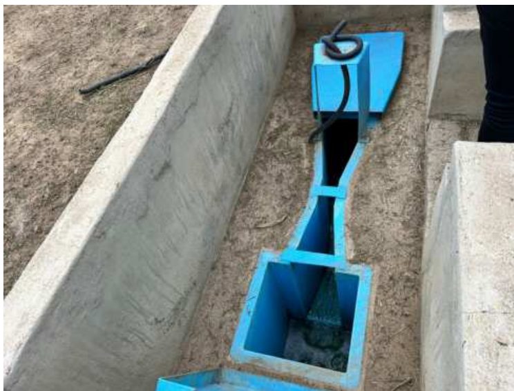
Foto 9 Saída do efluente tratado
