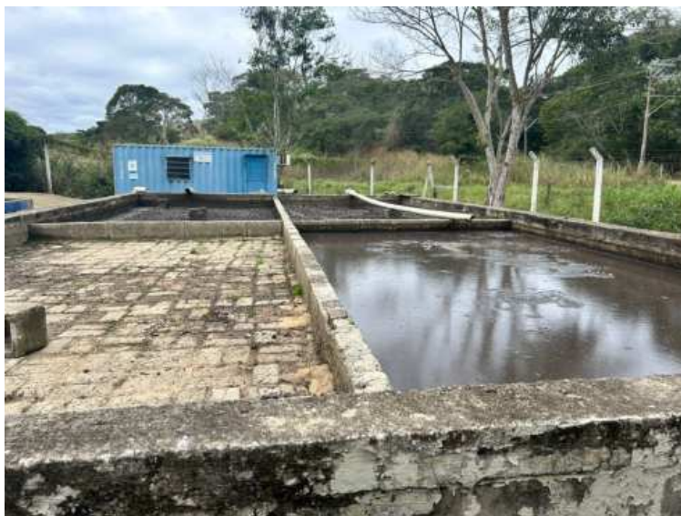
Foto 4 Leitos de secagem
