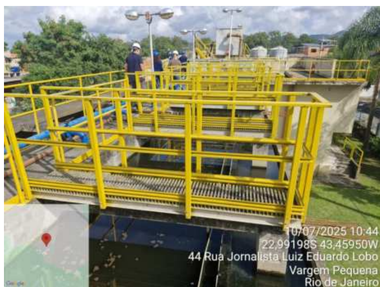
Foto 13 – decantador secundário e tanque de aeração
