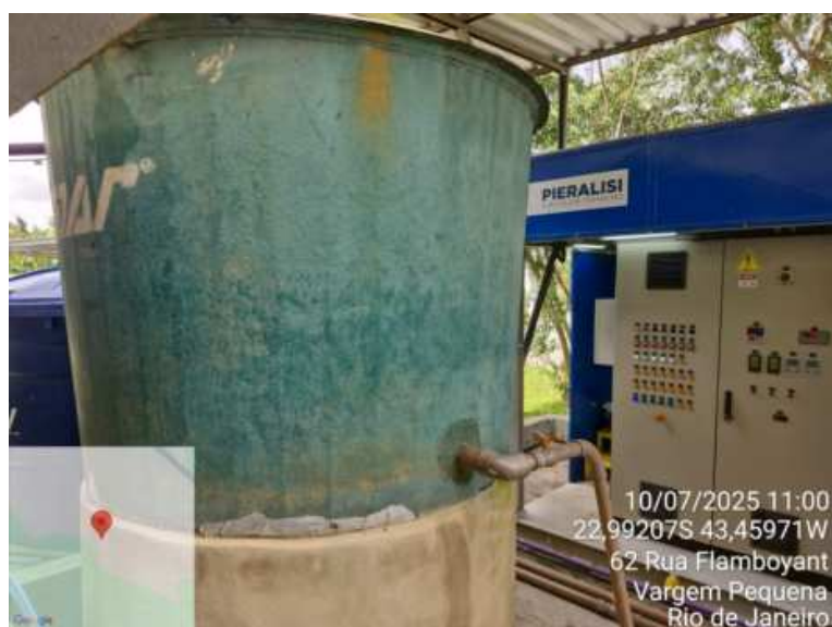
Foto 17 – tanque de armazenamento do lodo
