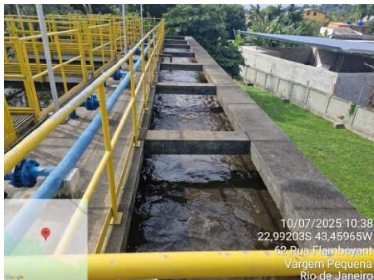
Foto 09 – tanque de aeração
