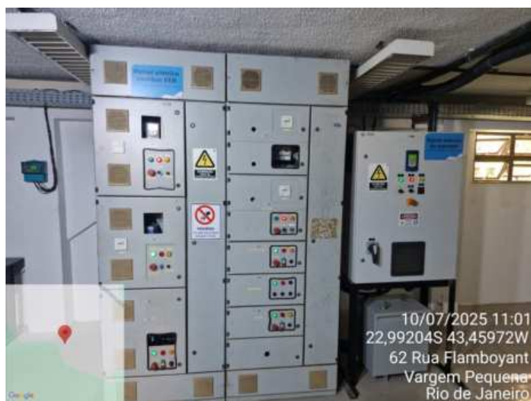
Foto 03 – Painel elétrico da EEB e do soprador
