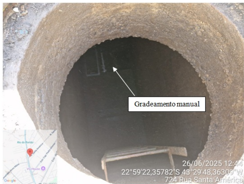
Foto 3 – Caixa receptora do esgoto
