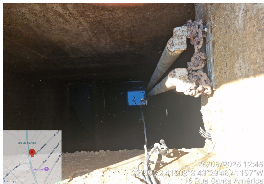
Foto 5 – Poço das Motobombas
