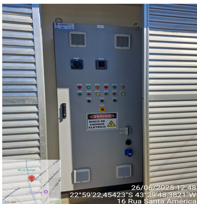
Foto 6 – Painel de controle das motobombas
