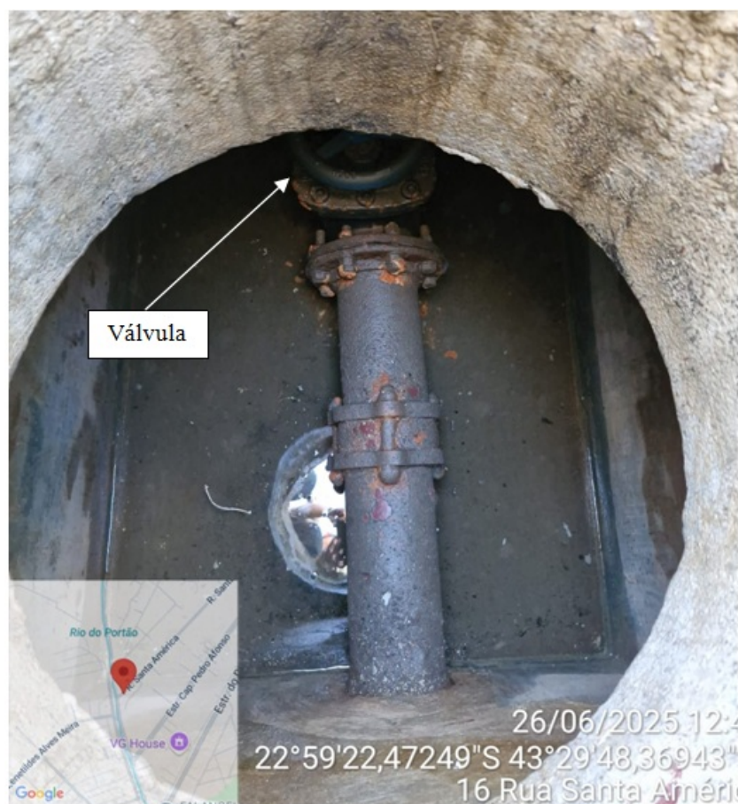
Foto 7 – Tubulação de recalque
