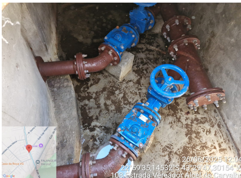
Foto 5 – Tubulações de recalque
