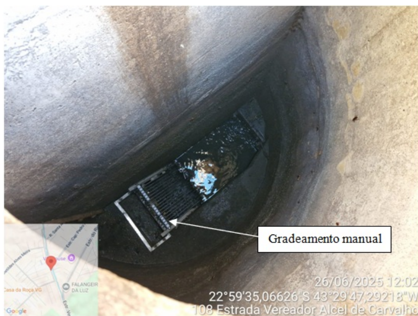
Foto 2 – Caixa receptora do esgoto
