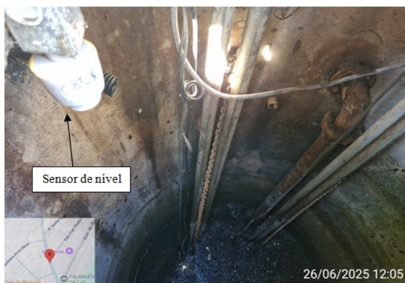
Foto 4 – Poço das Motobombas com sensor de nível
