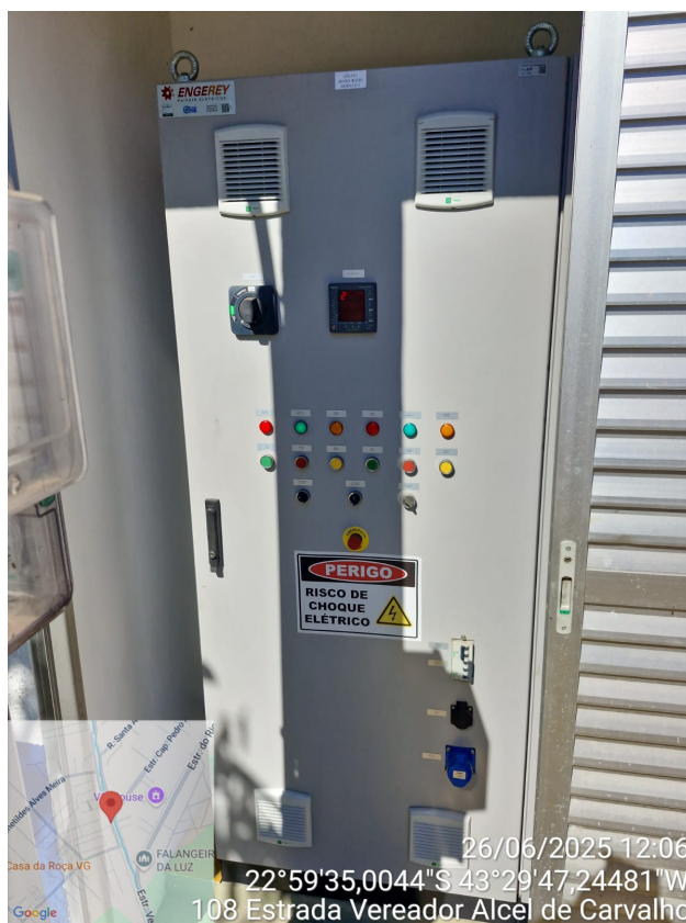
Foto 7 – Painel de controle das motobombas
