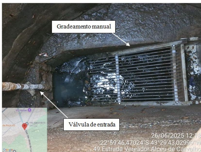
Foto 2 – Caixa receptora do esgoto
