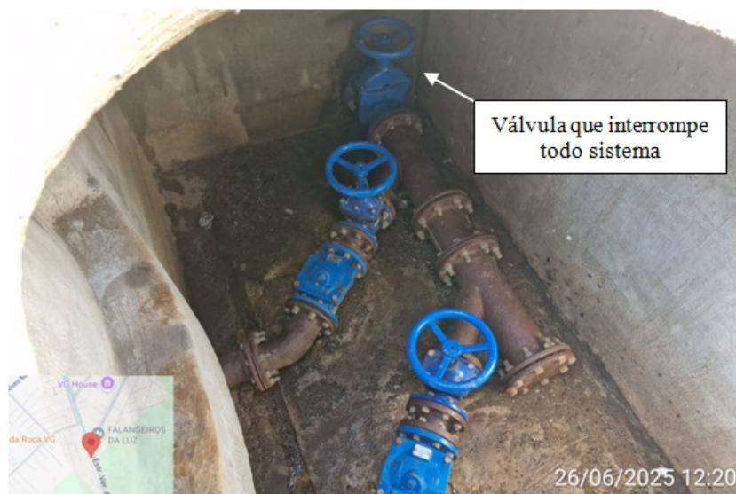
Foto 5 – Tubulações de recalque
