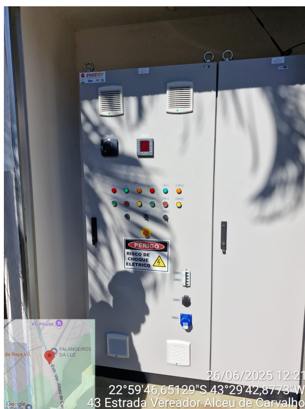
Foto 7 – Painel de controle das motobombas
