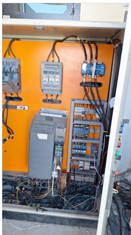
Foto 4 – Quadro elétrico da EEE com inversor de frequência e sistema de botoeiras para acionamento manual
