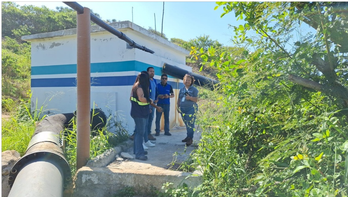
Foto 7 – Caixa de distribuição que recebe três recalques, inclusive da EEE Teatro
