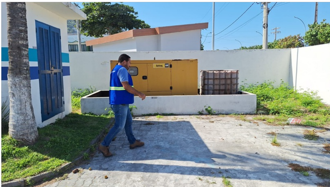
Foto 3 – Gerador com reservatório de combustível protegido por baia de contenção; Abrigo do quadro em bom estado de conservação
