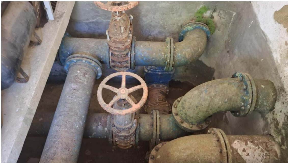
Foto 05 - Registros e tubulações
