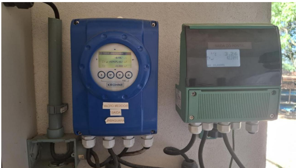
Foto 07 - Macromedidor de saída
