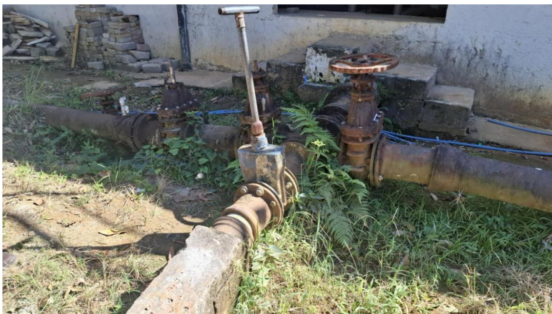
Foto 04 - Registros de manobra para operação
