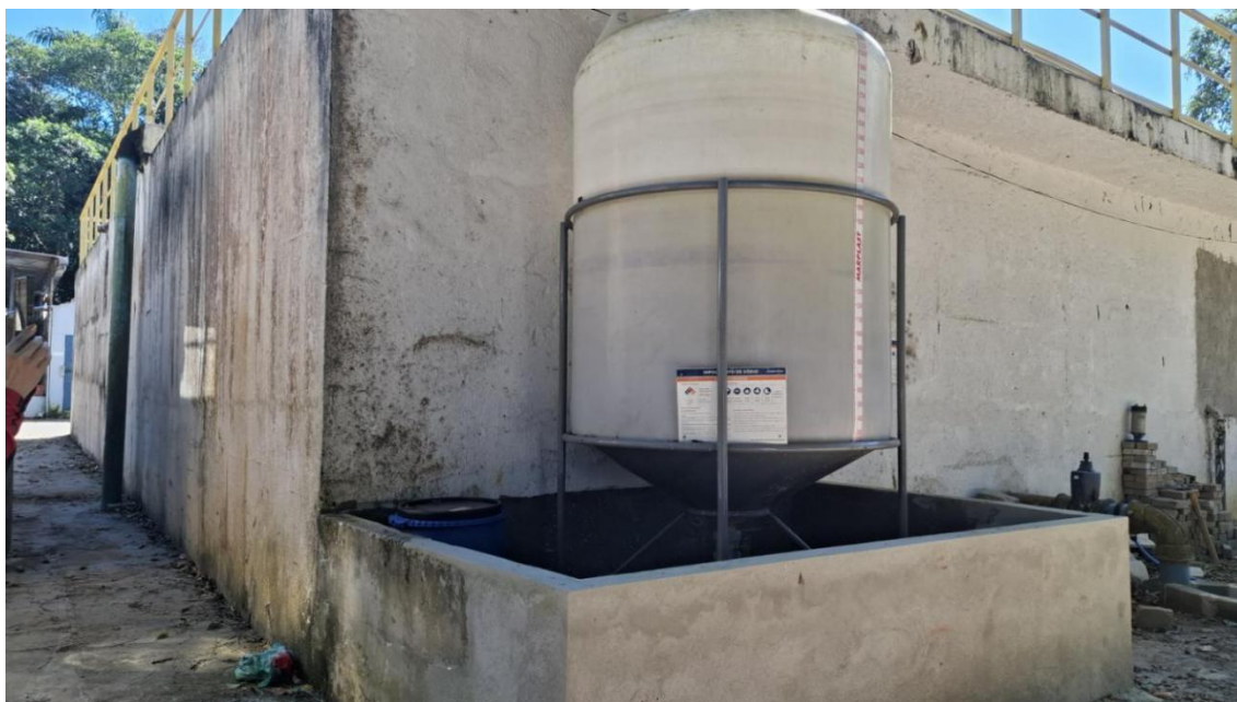
Foto 03 - Tanque de hipoclorito
