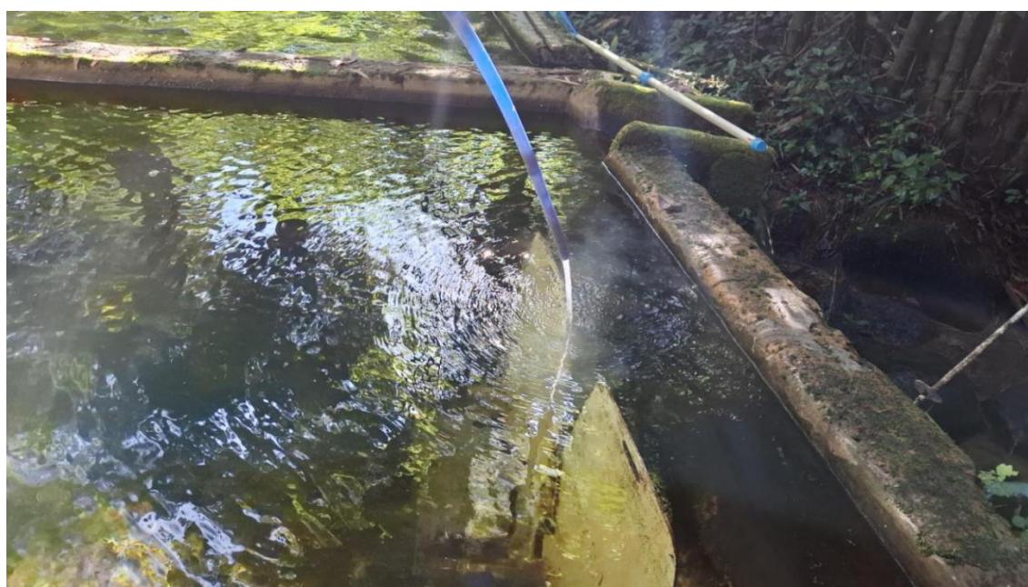
Foto 06 - Mangueira que realiza a cloração após passar pelo sistema
