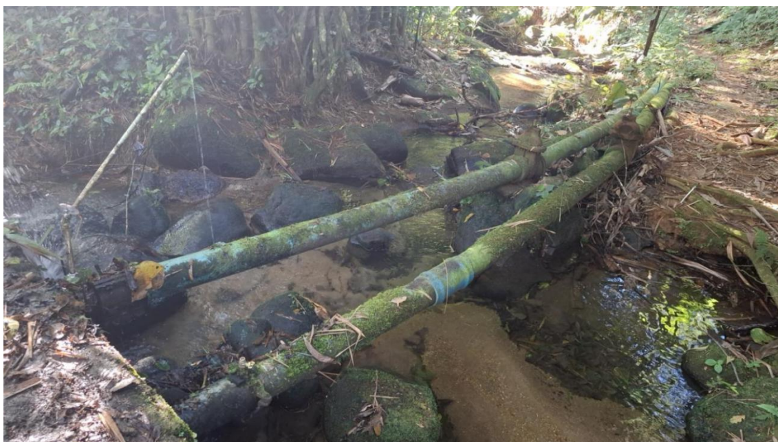
Foto 08 - Tubulações que fazem a adução até o reservatório
