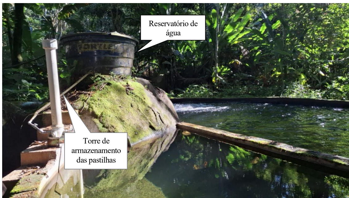
Foto 05 - Sistema de cloro em pastilha
