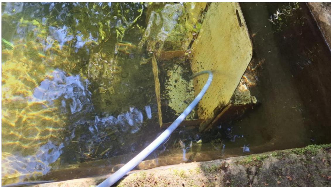
Foto 07 - Gradeamento antes da adução
