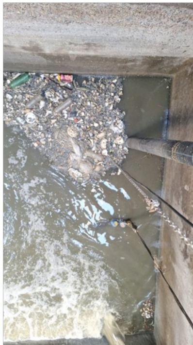
Foto 8 – Poço da EEE Valão com resíduos sólidos .
