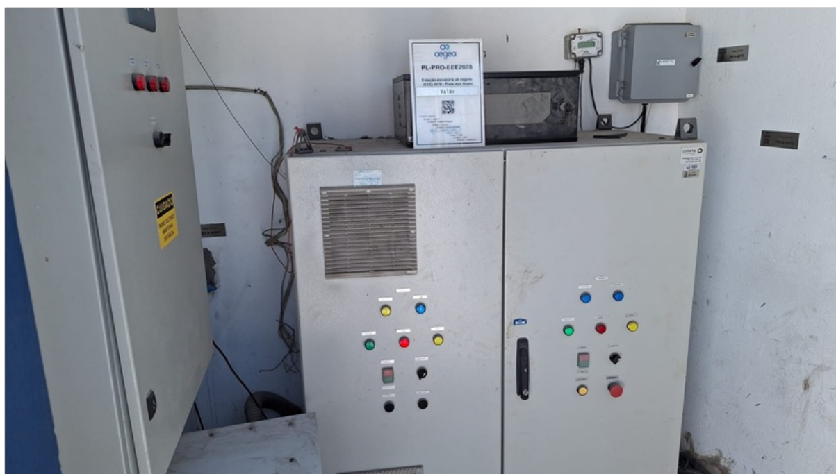
Foto 4 – Quadros elétricos da EEE com identificação interna.
