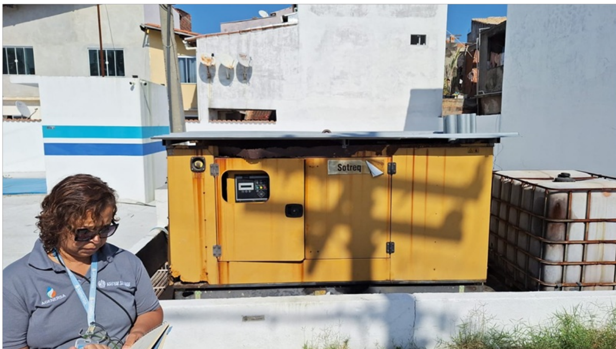
Foto 3 – Gerador com reservatório de combustível protegido por baia de contenção.
