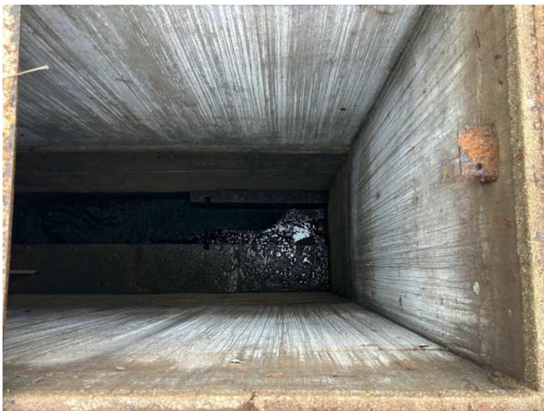
Foto 4 – Poço da chegada do esgoto sem gradeamento para remoção dos sólidos
