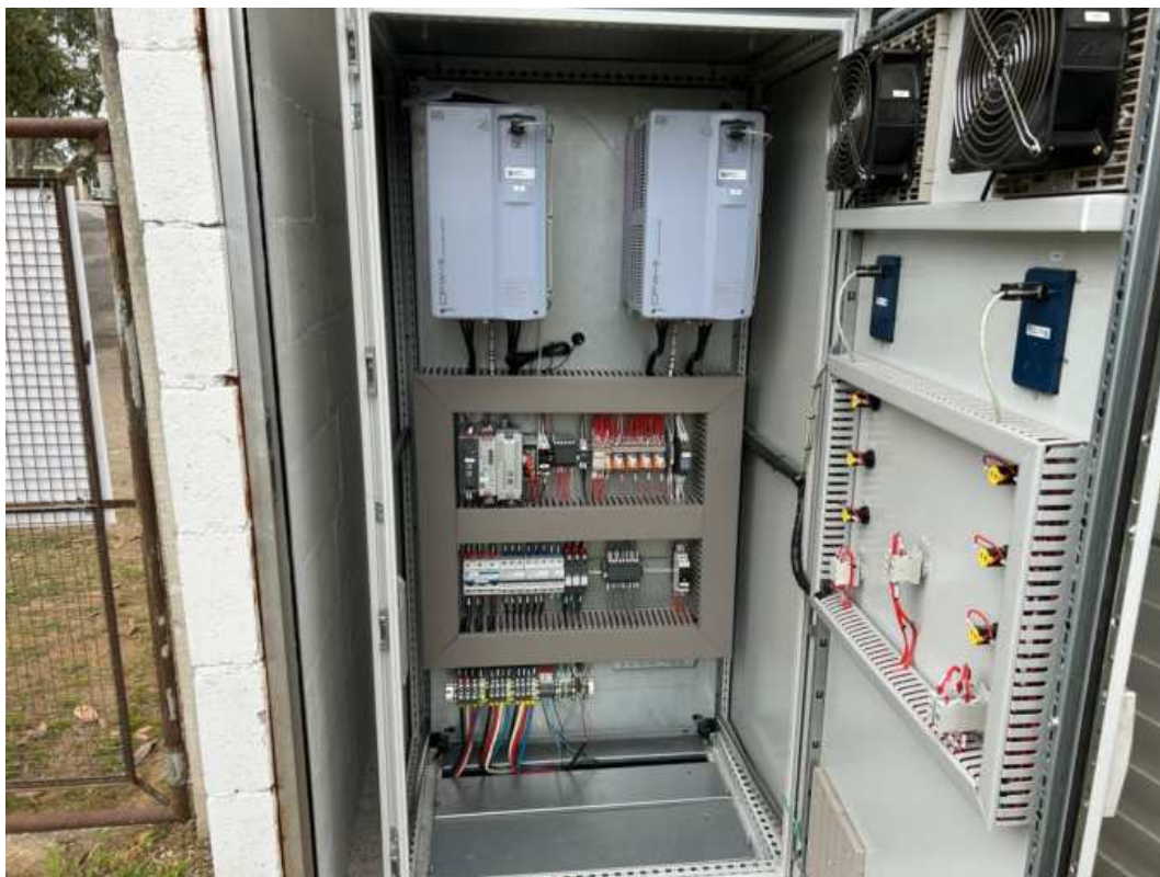
Foto 3 – Pannel da EEEB no abrigo
