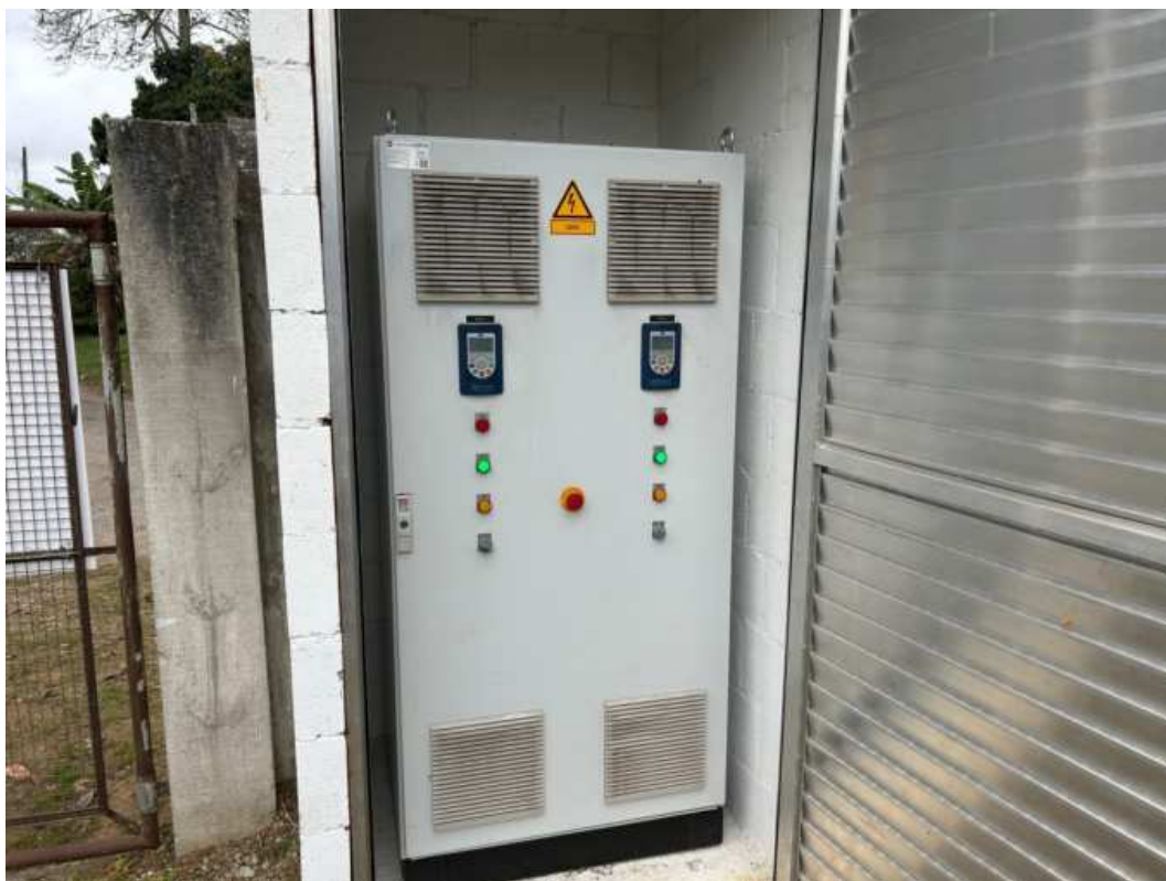
Foto 2 – Abrigo do painel da EEEB
