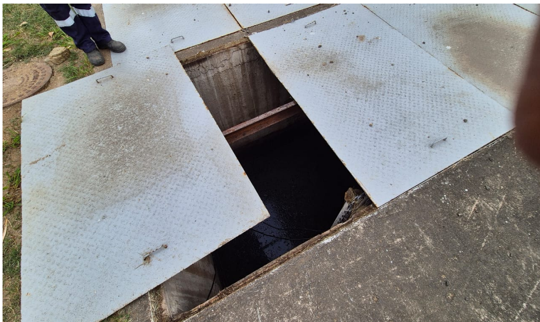
Foto 6 – Poço de sucção onde está instalado o conjunto motobomba
