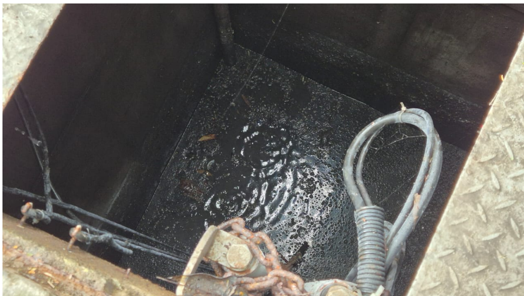
Foto 6 – Poço de sucção onde está instalado o conjunto motobomba
