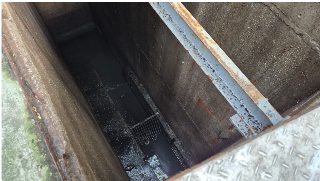
Foto 4 – Poço da chegada do esgoto com gradeamento para remoção dos sólidos
