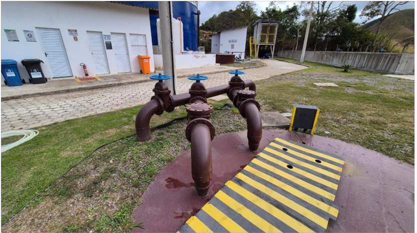
Foto 9 Elevatória da ETE - transporta parte do efluente para o reator UASB
