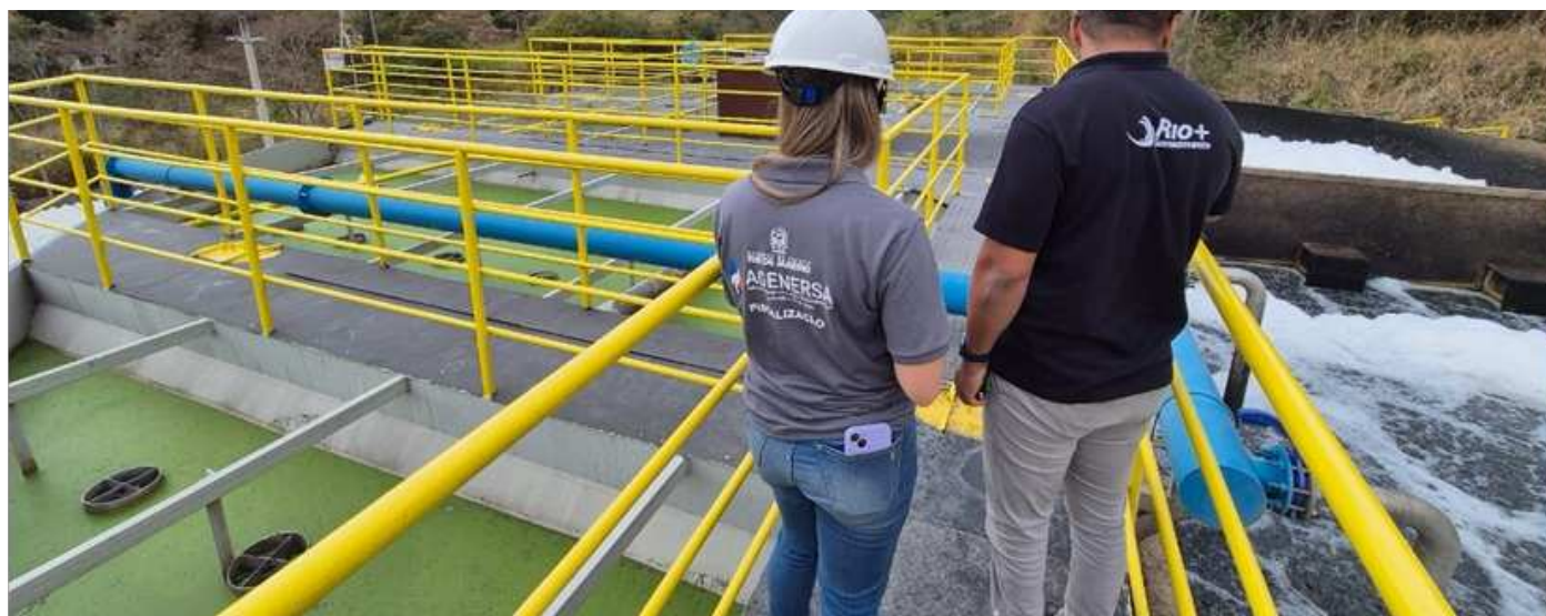
Foto 11 Vista superior do reator UASB
