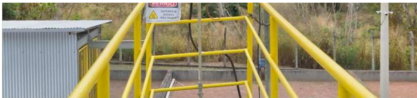
Foto 13 Queimador de gases da unidade
