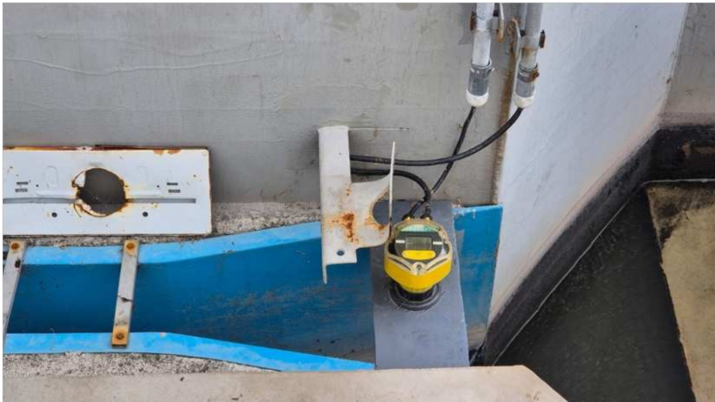
Foto 7 Medidor de vazão
