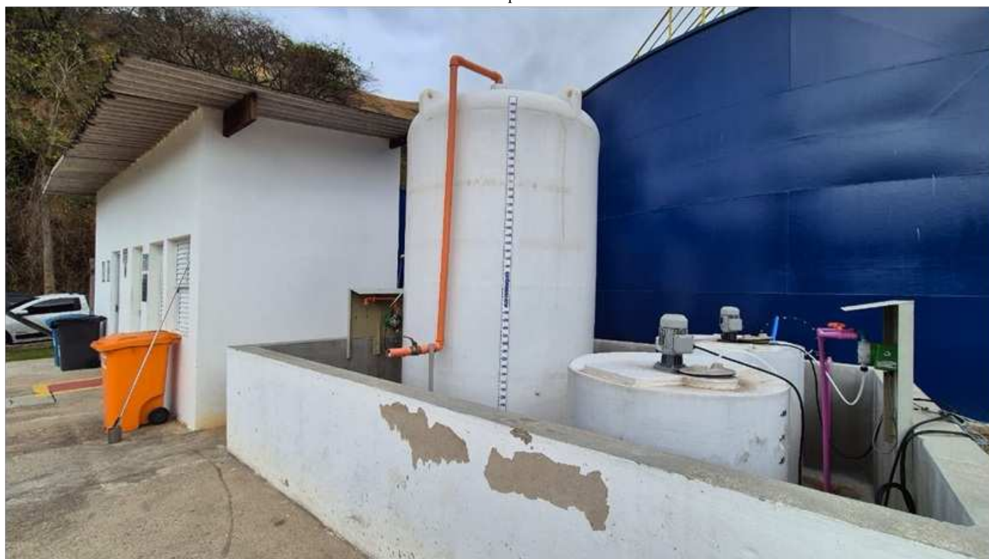
Foto 15 Tanque de armazenamento de coagulantes
