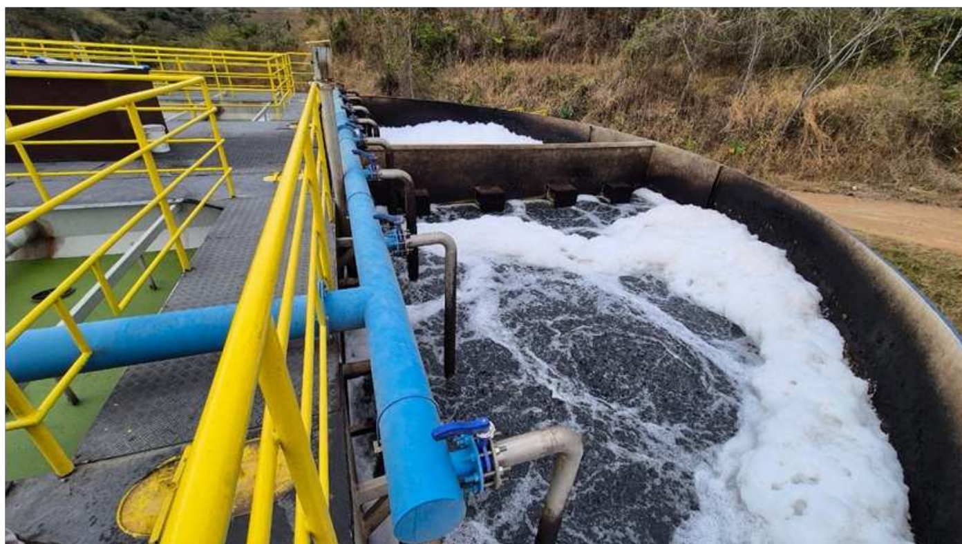
Foto 12 Sistema de aeração da ETE
