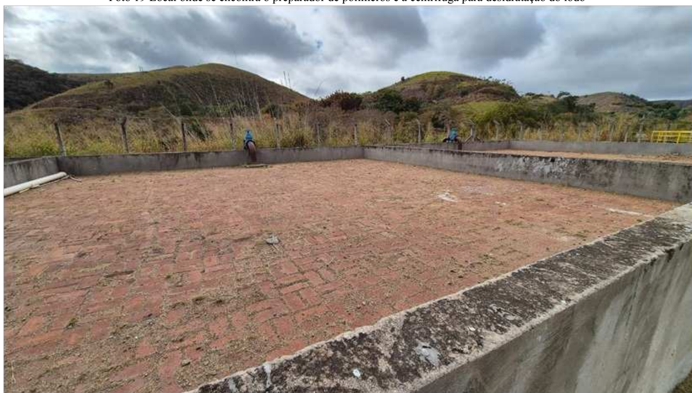
Foto 20 Leitos de secagem
