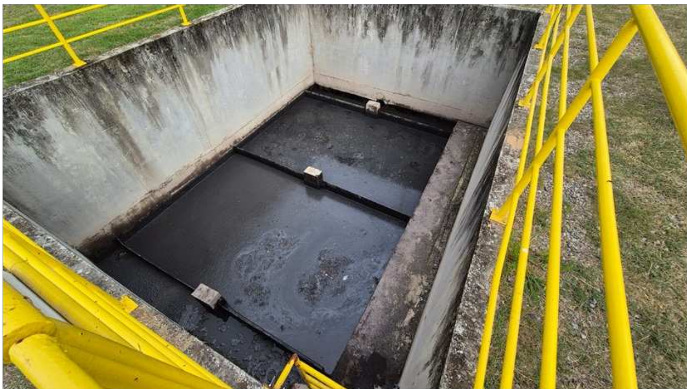
Foto 8 Caixa de gordura
