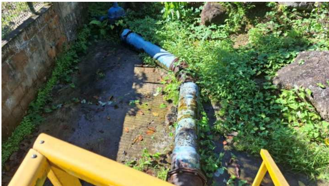
Foto 03 - Tubulação de adução para ETA
