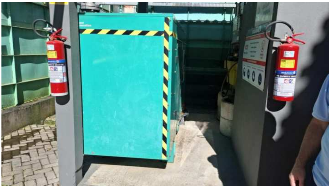
Foto 14 - Gerador de energia; acionado em caso de falha na rede elétrica
