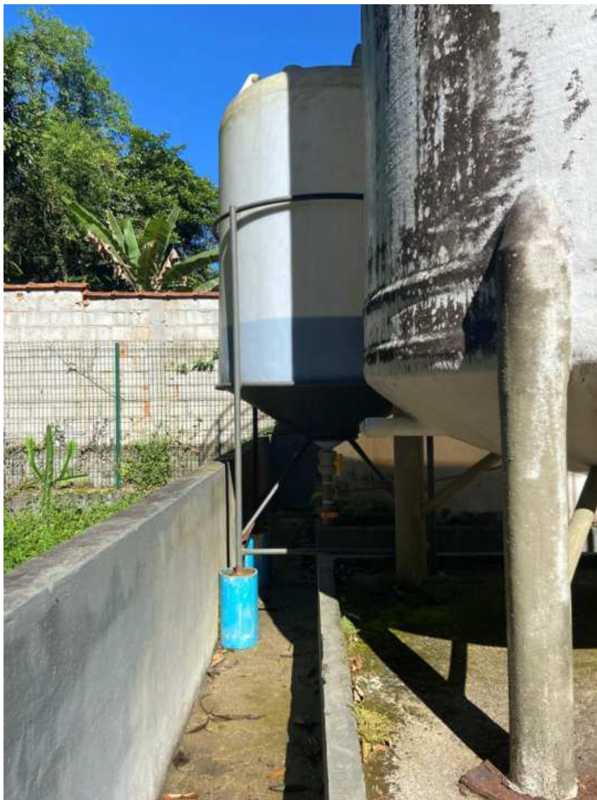
Foto 09 - Tanque de policloreto de alumínio (PAC)
