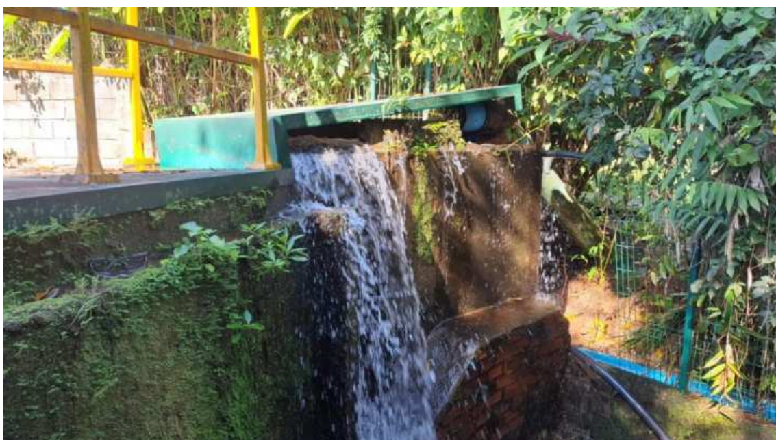
Foto 04 - Extravador do desarenador
