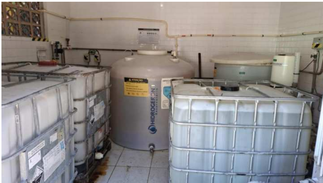
Foto 12 - Tanque de hipoclorito de sódio; realiza a cloração da água
