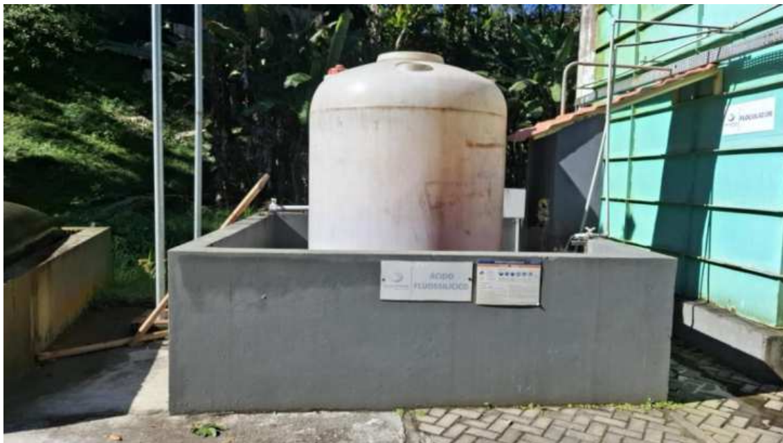
Foto 10 - Tanque de ácido fluossilícico; produto para fluoretação da água; possui bacia de contenção
