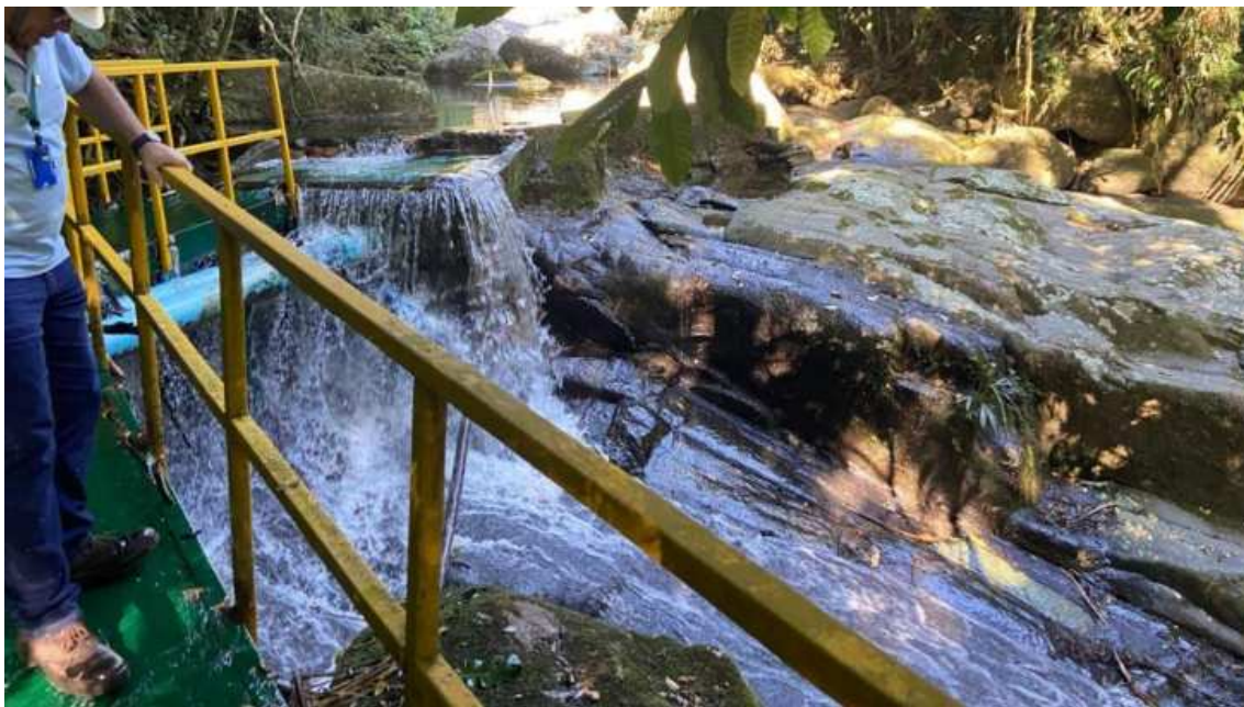
Foto 01 - Entrada do canal de captação
