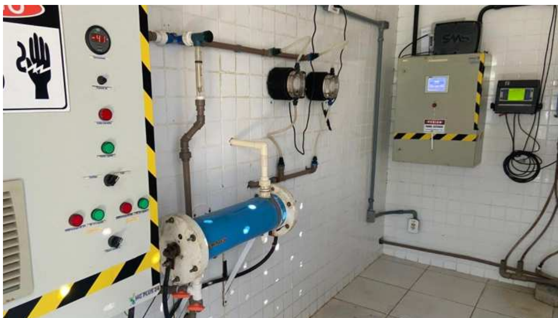
Foto 11 - Equipamento de eletrólise para produção de hipoclorito de sódio
