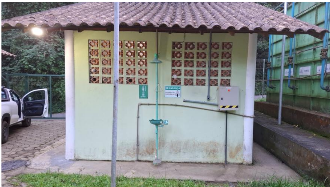
Foto 05 – Chuveiro de emergência e lava olhos
