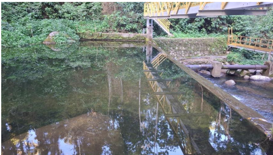
Foto 01 – Barragem da captação; limpeza realizada duas vezes ao ano para remoção de areia
