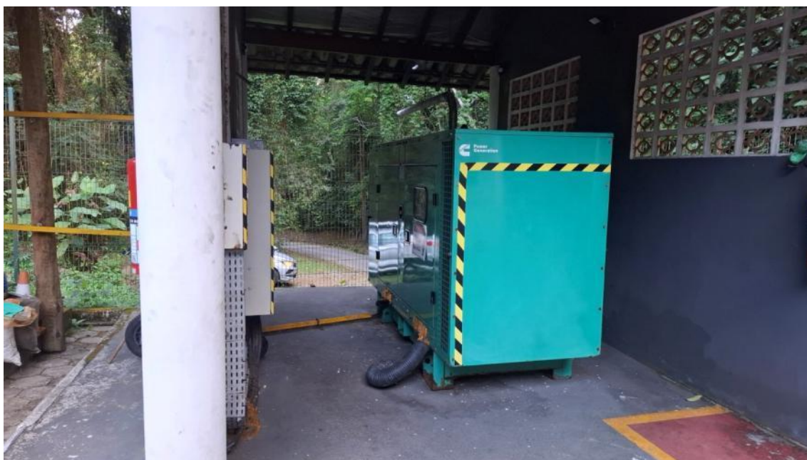
Foto 06 – Gerador de energia para emergências
