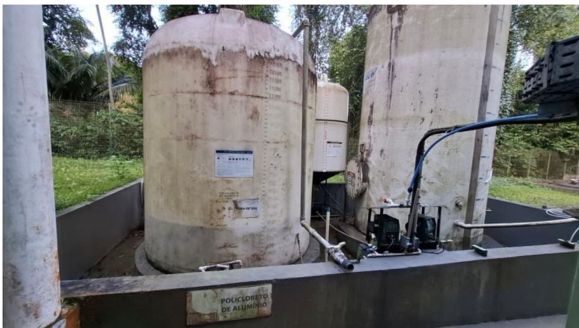
Foto 10 – Policloreto de alumínio; apenas um tanque funcionando e suficiente para realizar o tratamento; possui bacia de contenção
