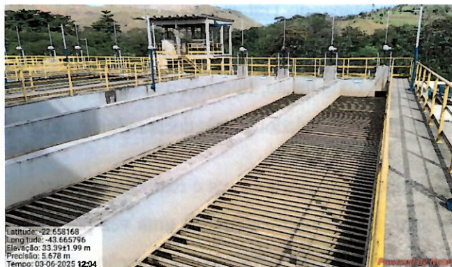
Foto 13: Vista dos floculadores.
