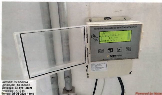
Foto 10: medidor de vazão automático.
