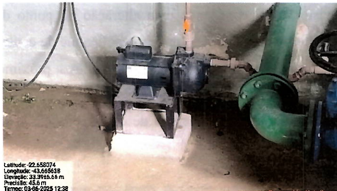
Foto 21: bomba sem vazamento.
