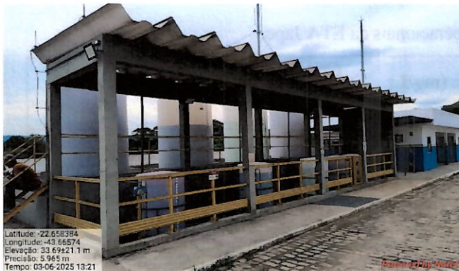
Foto 36: Tanques de armazenamento de produtos químicos utilizados no tratamento.
