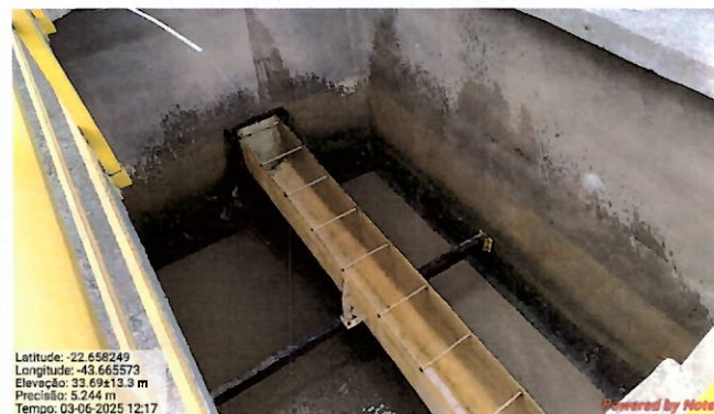
Foto 17: Filtro sendo limpo.
