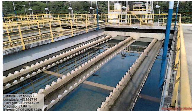
Foto 15: Vista dos decantadores.
