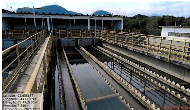
Foto 14: Vista dos decantadores.
