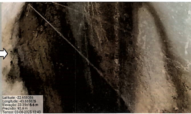
Foto 23: vazamento em tanque de descarga de filtros.
