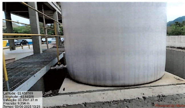
Foto 39: Bacia de contenção.
