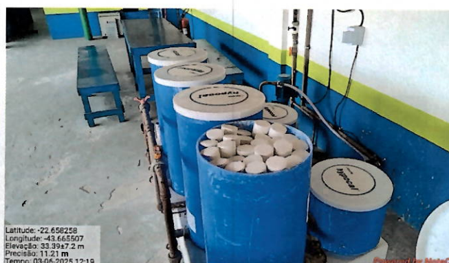
Foto 19: Sistema de desinfecção com hipoclorito de cálcio.
