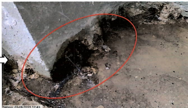
Foto 25: vazamento em tanque de descarga de filtros.
