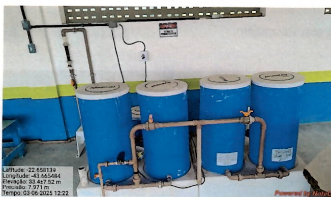
Foto 18: Sistema de desinfecção com hipoclorito de cálcio.
