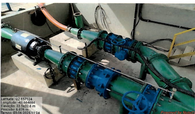
Foto 4: Bomba padrão e conexão de bomba provisória.
