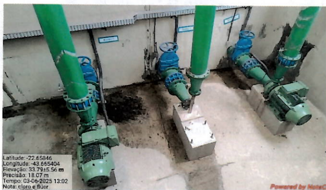
Foto 28: Conjuntos motobombas (nota-se o conjunto do meio foi retirado para manutenção).
