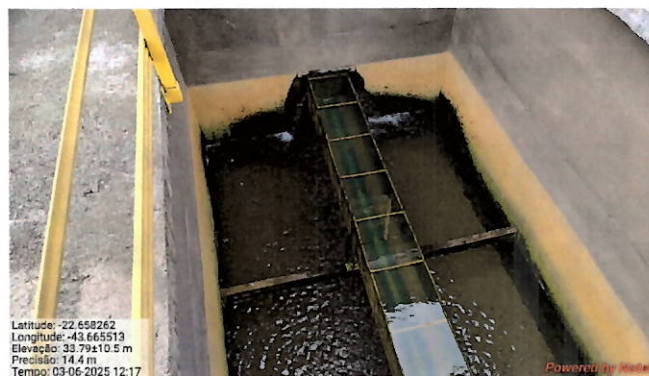
Foto 16: Filtro em operação.
