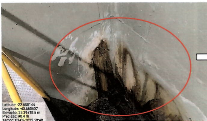
Foto 22: vazamento em tanque de descarga de filtros.
