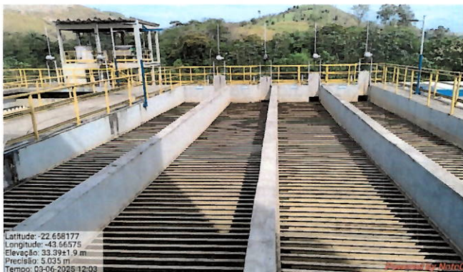
Foto 12: Vista dos floculadores.
