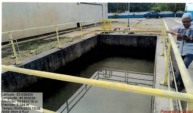
Foto 40: Tanque de chegada de águas residuais.
