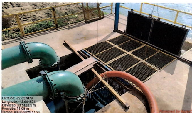
Foto 2: Sistema de gradeamento.
