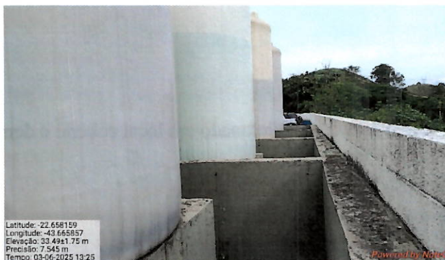
Foto 38: Bacias de contenção.
