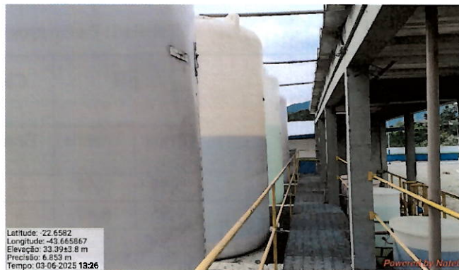
Foto 37: Tanques de armazenamento de produtos químicos com capacidade de 10.000 L cada.
