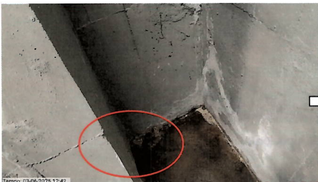
Foto 24: vazamento em tanque de descarga de filtros.
