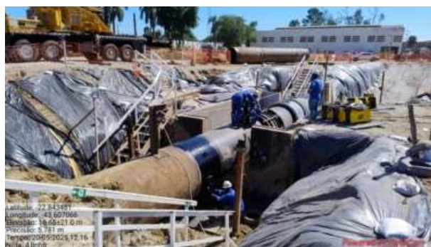
Foto Nº 5 – Macromedidor 4ª linha
