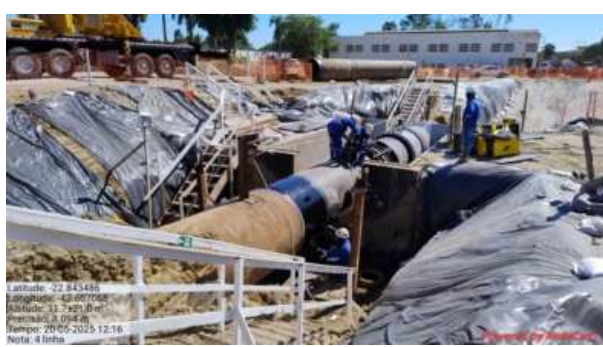
Foto Nº 4 – Macromedidor 4ª linha.
