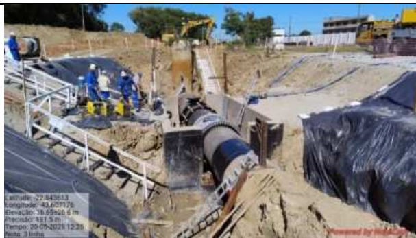
Foto N° 13 – Macromedidor 3ª linha
