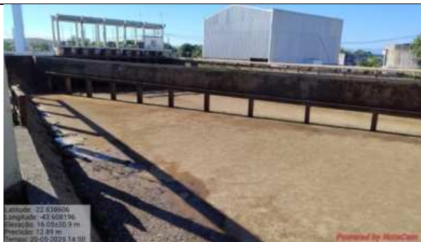
Foto N° 26 – Tranque tranquilização de entrada de água bruta na estação de tratamento.
