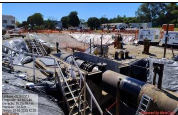
Foto Nº 11 – Macromedidor 4ª linha
