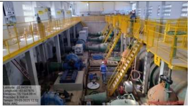
Foto nº 20 – Galeria de bombas do Alto Recalque do Guandu - ARG
