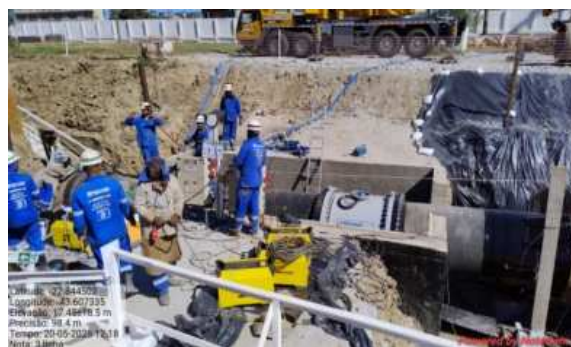
Foto Nº 6 – Macromedidor 3ª linha
