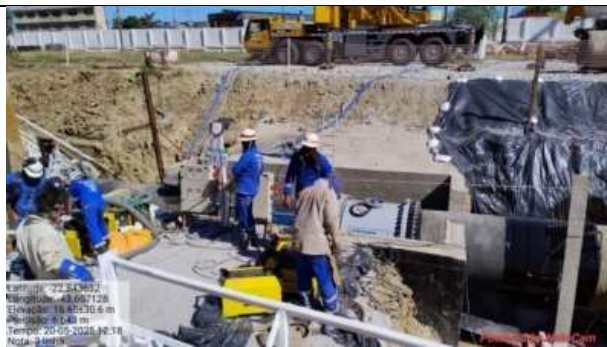
Foto Nº 7 – Macromedidor 3ª linha
