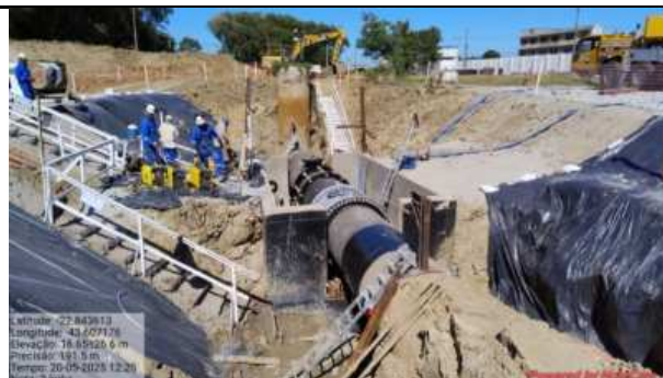
Foto Nº 10 – Macromedidor 3ª linha
