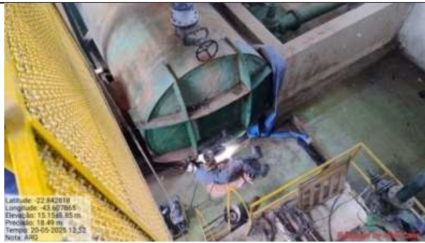
Foto Nº 19 – Inspeção do vazamento no barrilete do ARG
