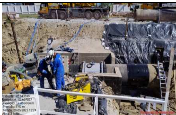
Foto Nº 12 – Macromedidor 3ª linha
