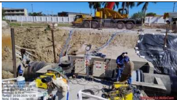
Foto Nº 9 – Macromedidor 3ª linha
