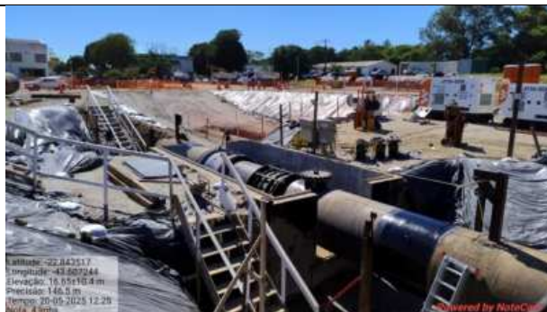
Foto N° 14 – Macromedidor 4ª linha
