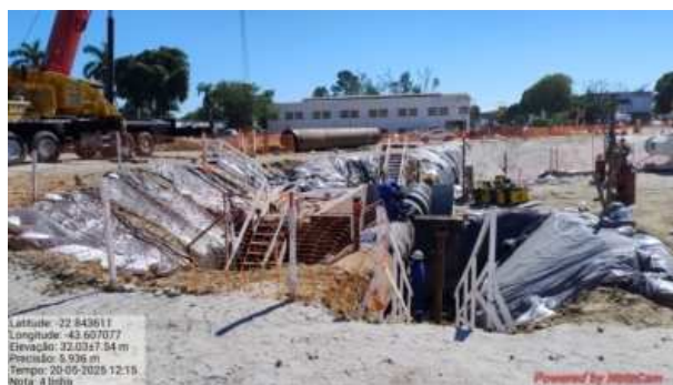
Foto Nº 3 – Macromedidor 4ª linha.
