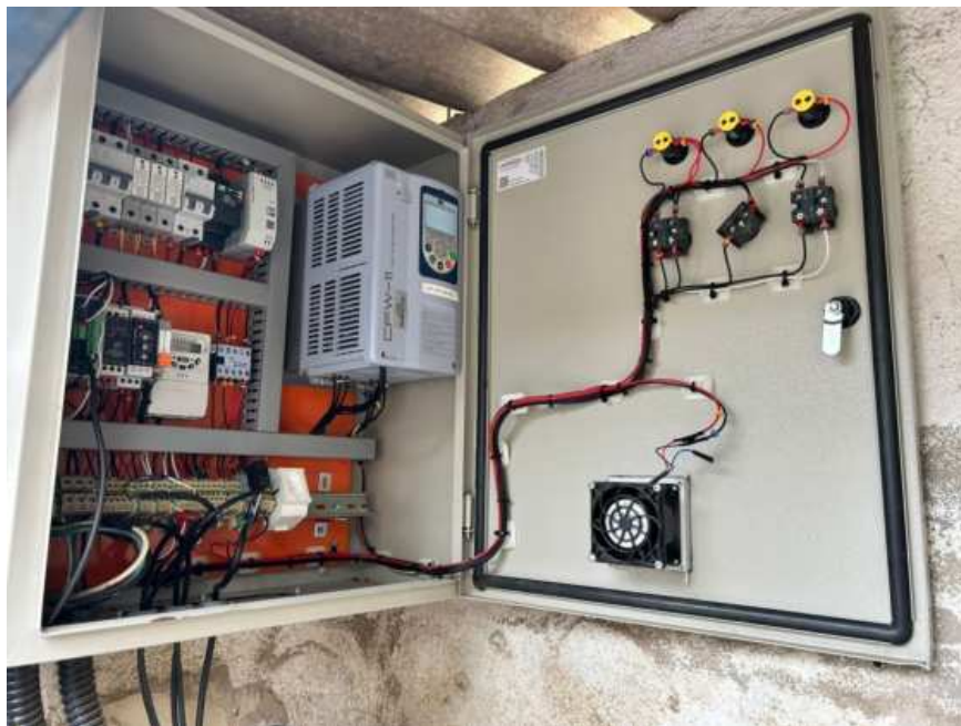
Foto 5 – Interior do painel de automação e visualização do inversor de frequência
