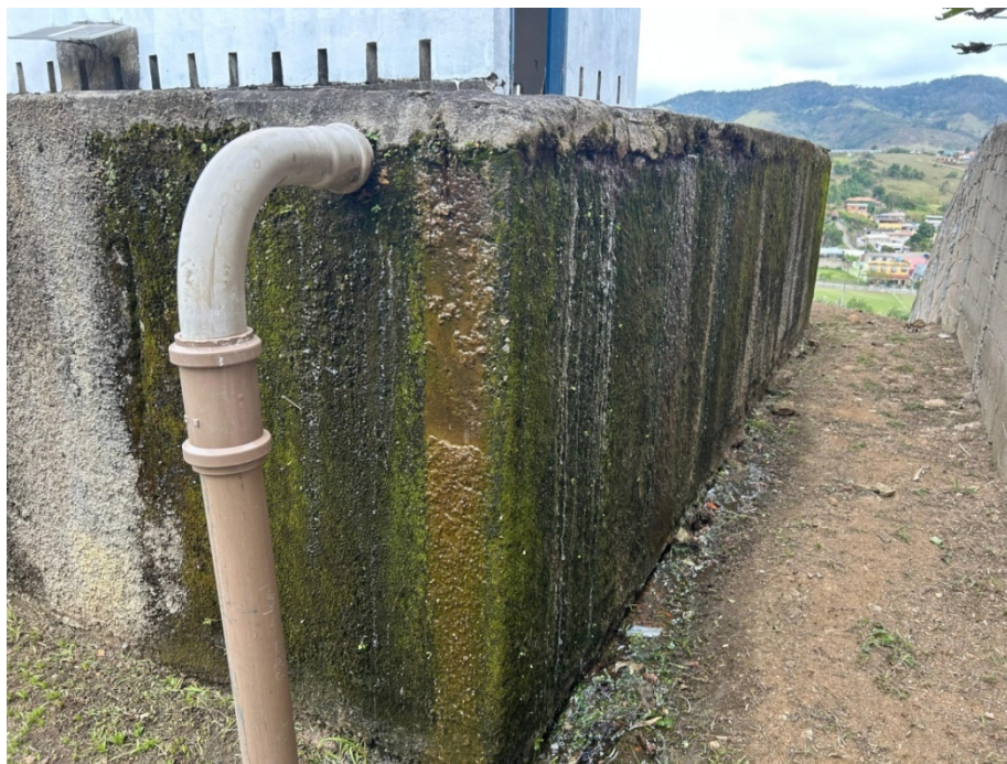
Foto 3 – Pontos de vazamento observados
