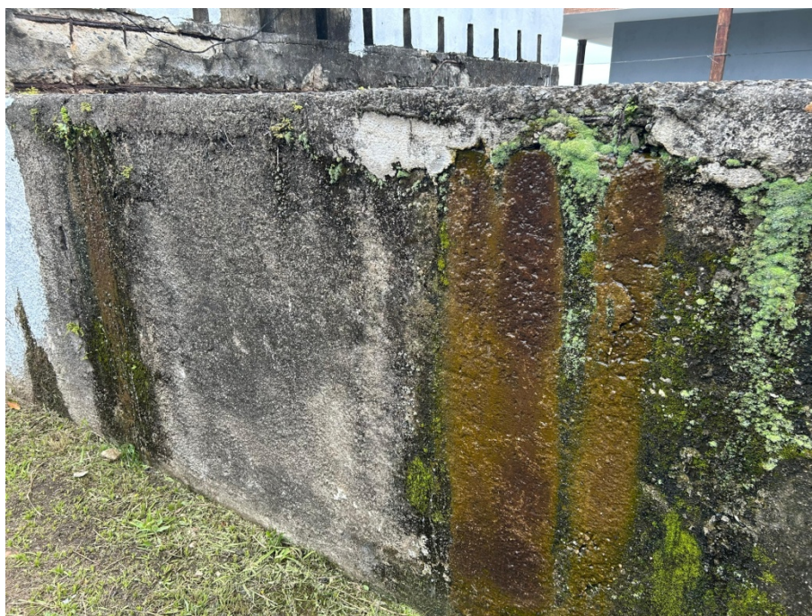
Foto 2 – Pontos de vazamentos e ferragens aparentes observados na parede do reservatório
